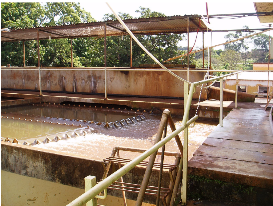
ETA – SAIDA DA ÁGUA DECANTADA
