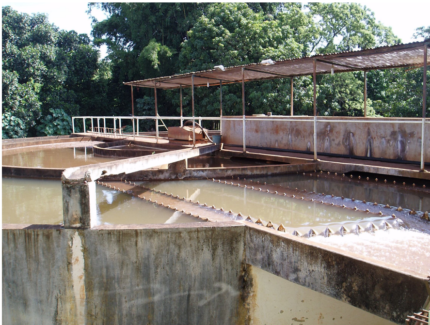
ETA – CANAL DE CHEGADA E UNIDADE DE TRATAMENTO POR COÁGULO SEDIMENTAÇÃO
