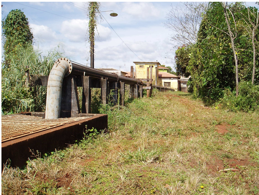
CAPTAÇÃO DE ÁGUA BRUTA DO CÓRREGO SÃO JOAQUIM (SUCÇÃO)
