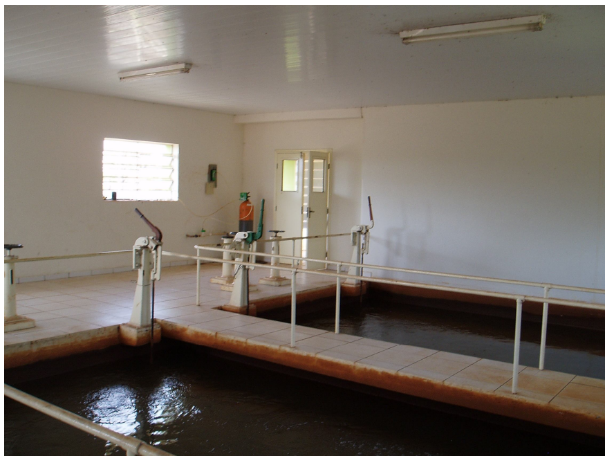
ETA-FILTROS E CLORADOR
