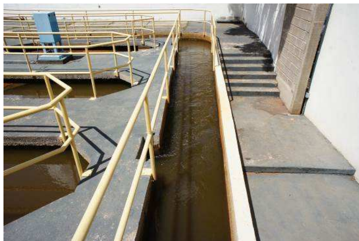
Figura 38 Vista geral de uma das comportas de saída de água floculada de uma das unidades de floculação
