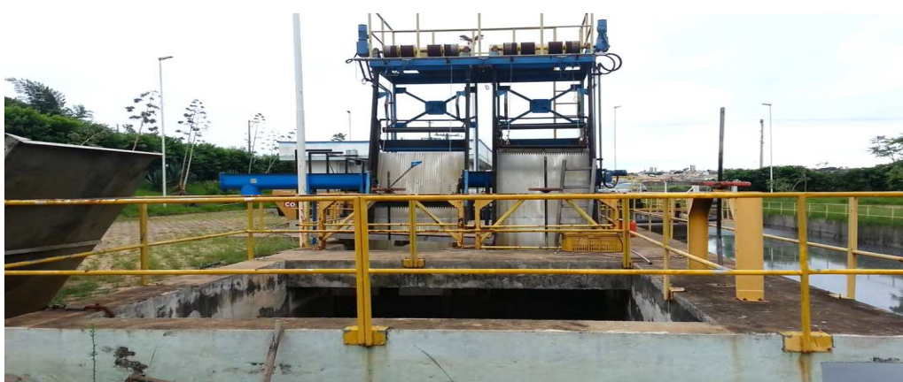
Vista do gradeamento do tratamento preliminar
