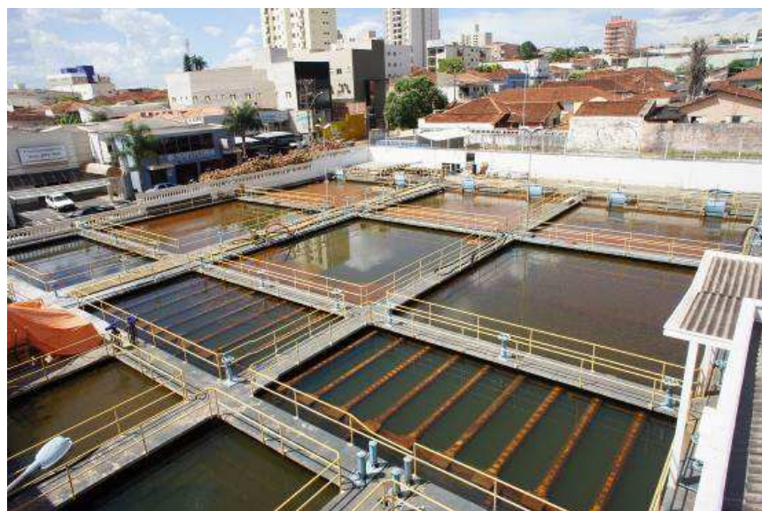
Figura 39 Vista geral dos decantadores
