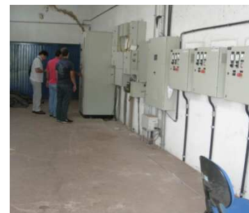
Sala de painéis
