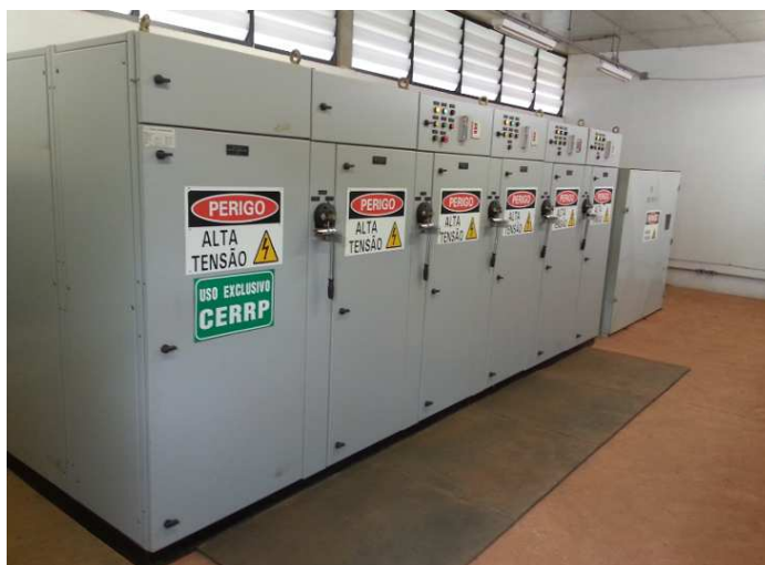
Figura 133 Cubículos da Subestação Principal e Trafo Auxiliar
