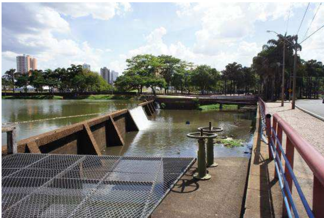
Figura 18 Captação 2 - ETA Palácio das Águas
