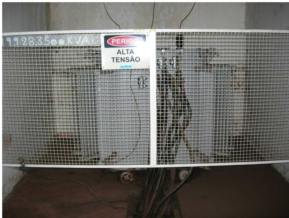
Figura 97 Secundário do trafo para diferentes painéis
