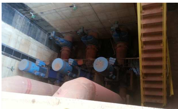
Figura 135 EEEB: conjuntos moto bomba
