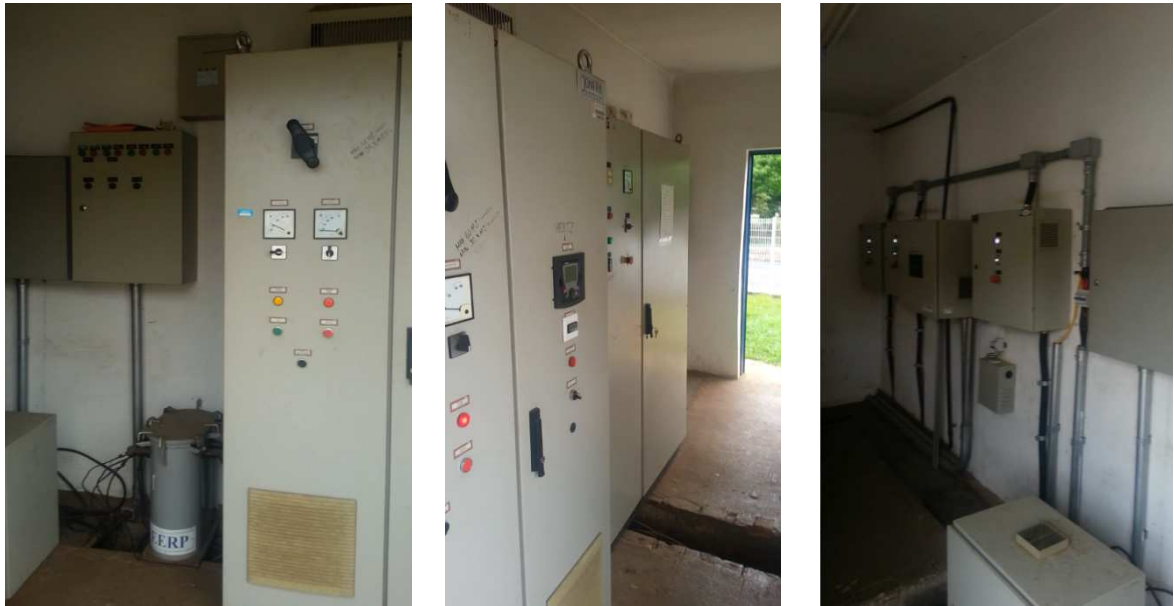
Figura 113 Painéis e trafo auxiliar
