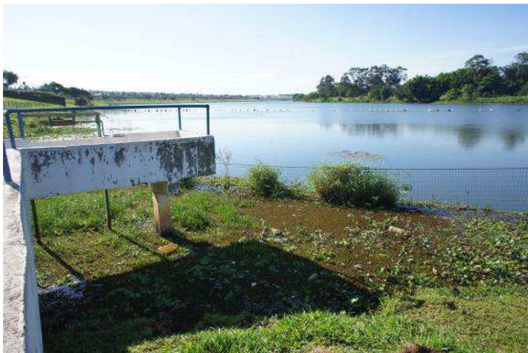
Figura 17 Captação 1 - ETA Palácio das Águas
