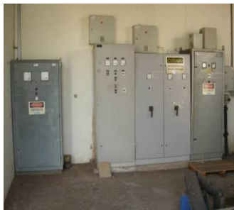
Alto Alegre - Painéis: quadro, acionamentos e capacitores
