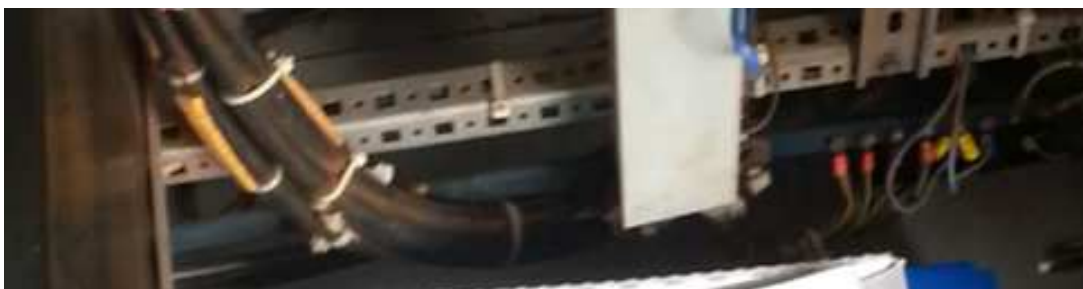
Figura 145 Vista do barramento deteriorado
