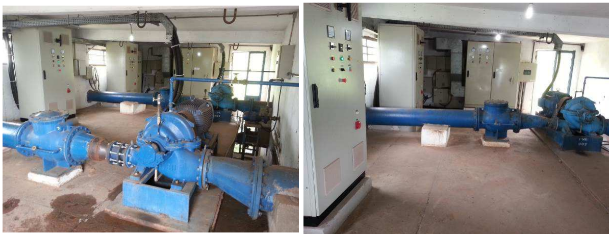
Figura 110 Casa de máquinas e painéis
