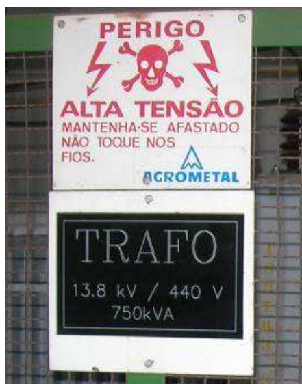
Figura 117 Placa de identificação de transformador de 750 kVA
