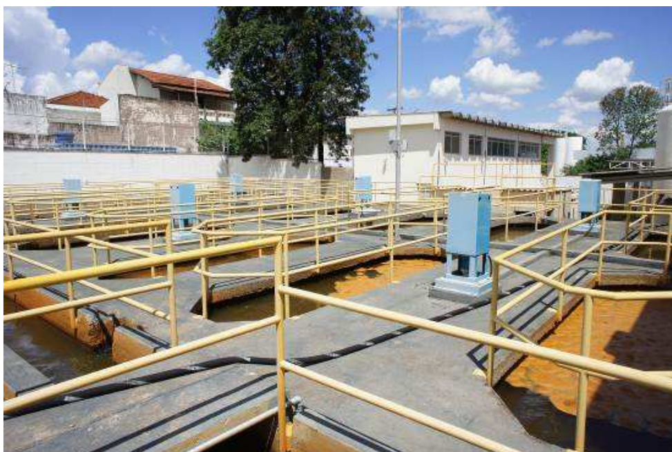
Figura 37 Vista geral do sistema de floculação
