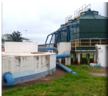
Outro reservatório semiapoiado e torre de resfriamento
