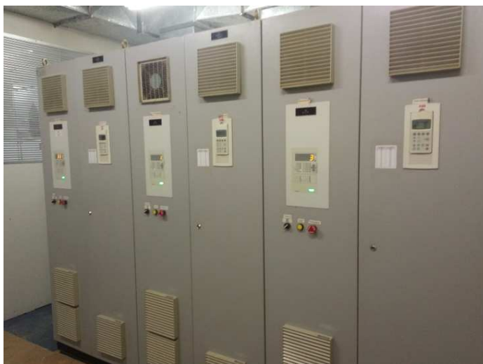
Figura 139 Inversores dos motores da EEEB
