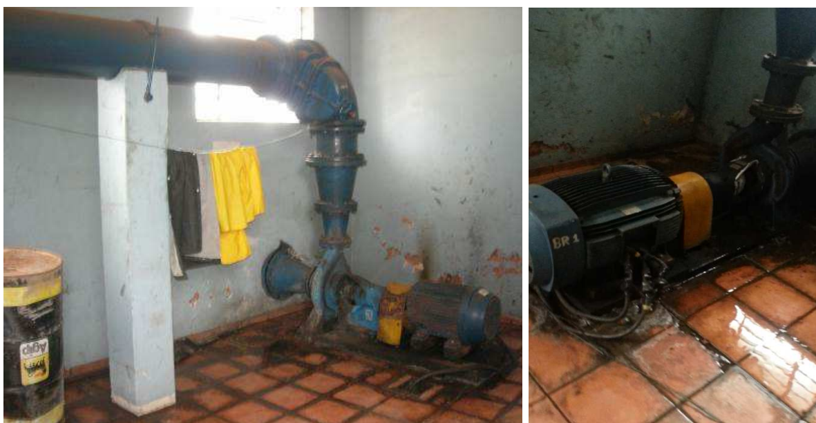
Figura 125 Casa de bombas – cjs de 100CV-220Vca
