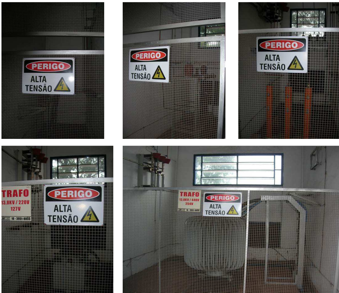
Figura 128 Sequência de Fotos da Subestação
