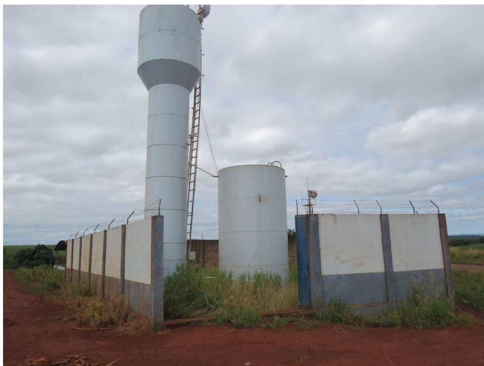
Foto 3.9 – Reservatórios Interligados do Bairro Água Suja
