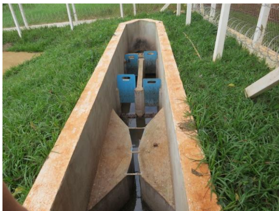
Foto 3.14 – Tratamento preliminar (Calha Parshall e Caixa de Areia)
