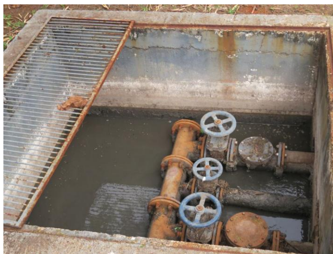
Foto 3.11 - Poço de sucção – EEE Rodovia Sebastião Coelho
