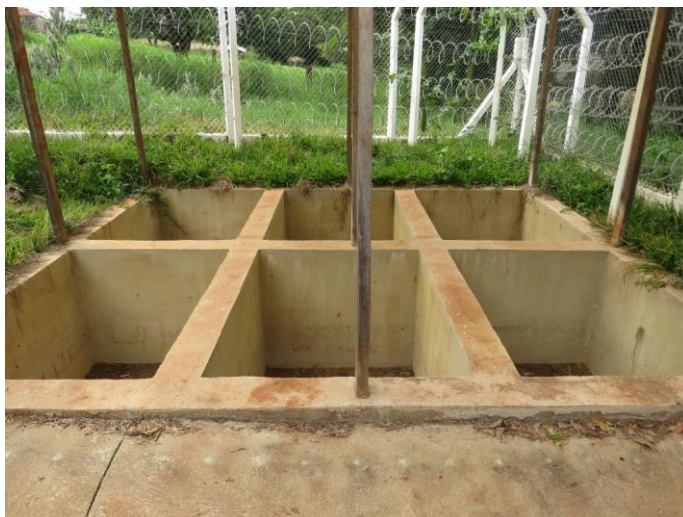
Foto 3.17 – Leito de secagem do lodo
