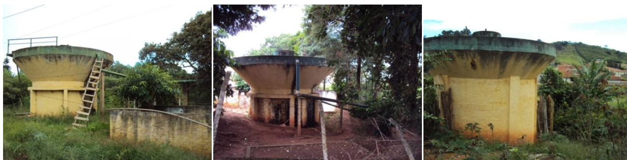
Figura 41: Estações de tratamento de esgoto - sem funcionamento.
