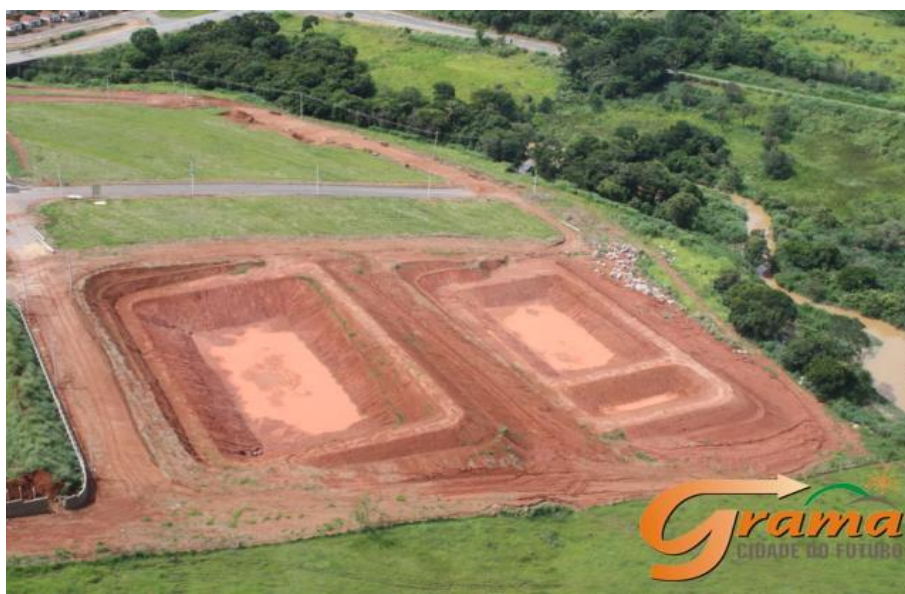
Figura 43: Lagoas para tratamento do esgoto.
