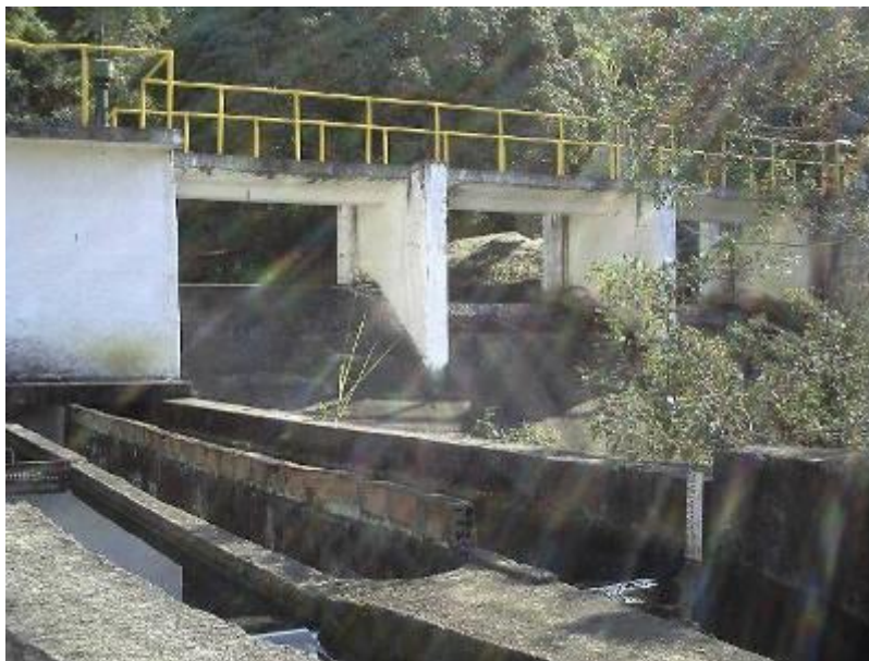
Foto 01 – Captação São Francisco (Fonte: SABESP)
