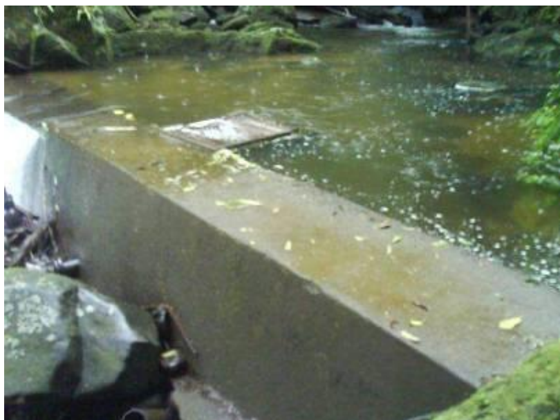
Foto 06 – Captação Córrego da Barra (Fonte: SABESP)
