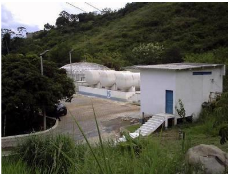
Foto 02 – Filtros da Estação de Tratamento de Água São Francisco (Fonte: SABESP)
