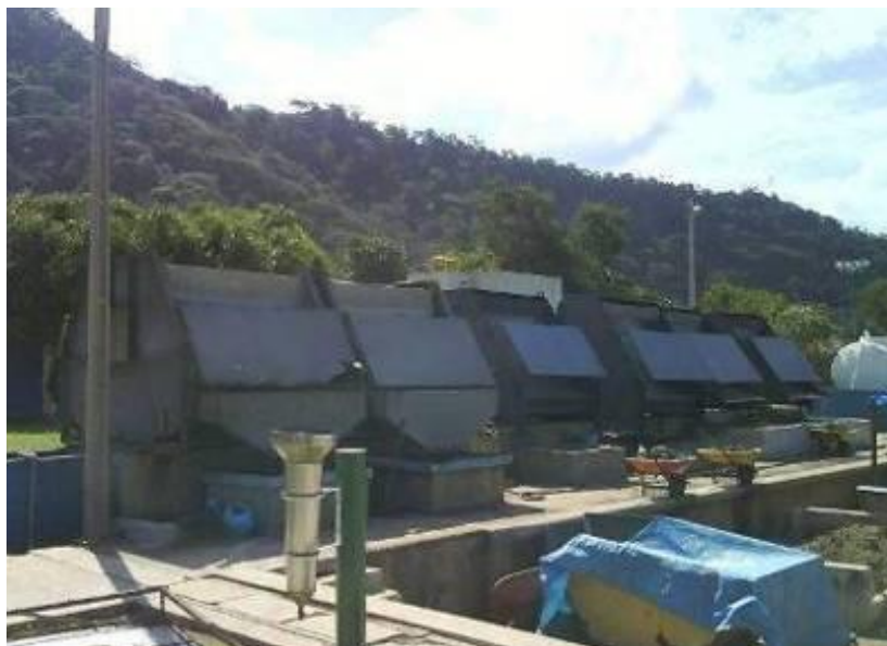
Foto 12 – Estação de Pré-Condicionamento Itatinga (Fonte: SABESP)
