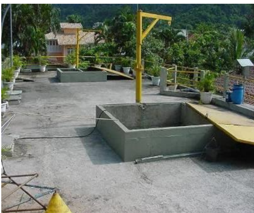
Foto 15 – Tanque de Aeração – ETE Barequeçaba (Fonte: SABESP)
