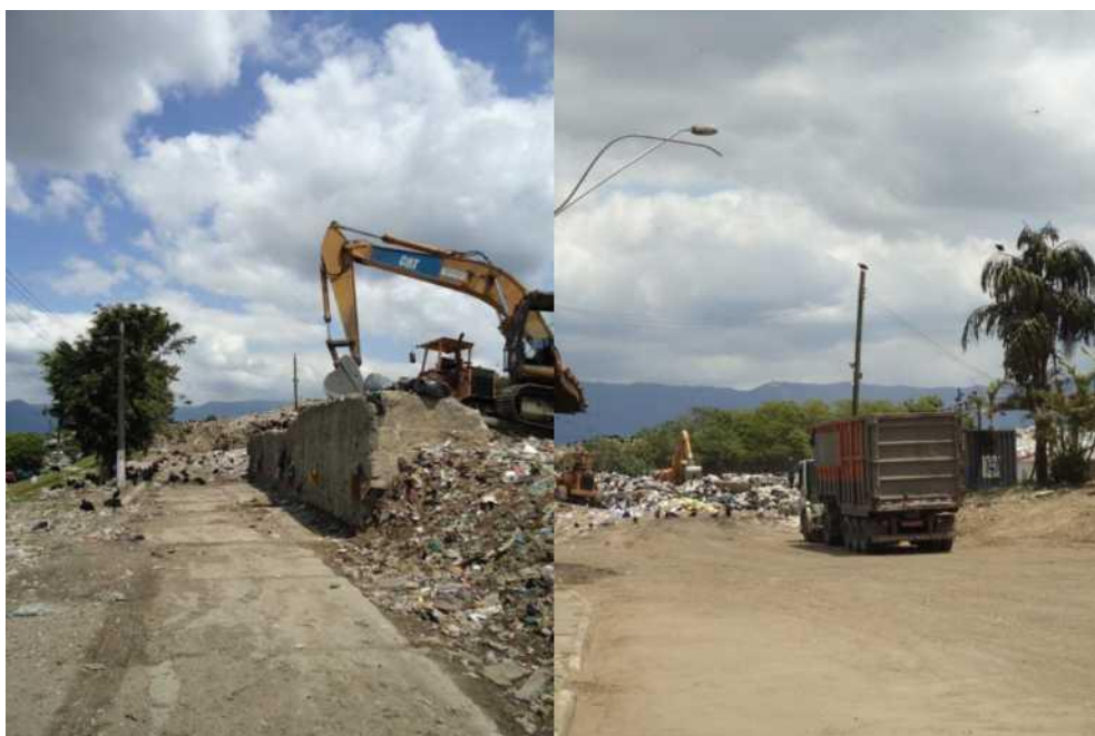
Figura 41: Área de carregamento e a carreta que realiza o transporte dos resíduos até o Aterro Sanitário Sítio das Neves
