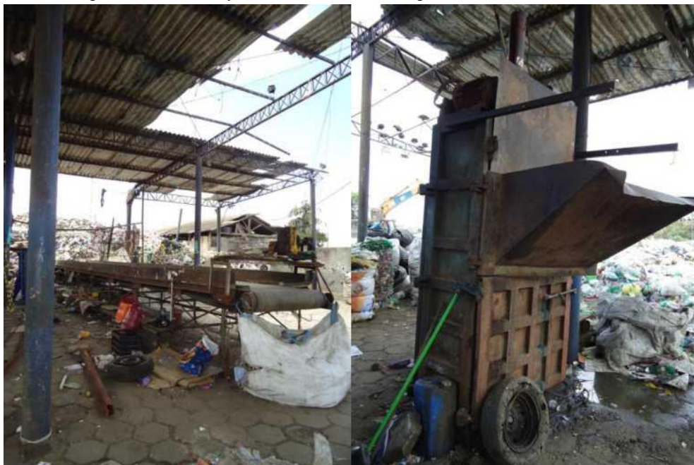
Figura 37: Esteira e prensa do Centro de Triagem de materiais recicláveis
