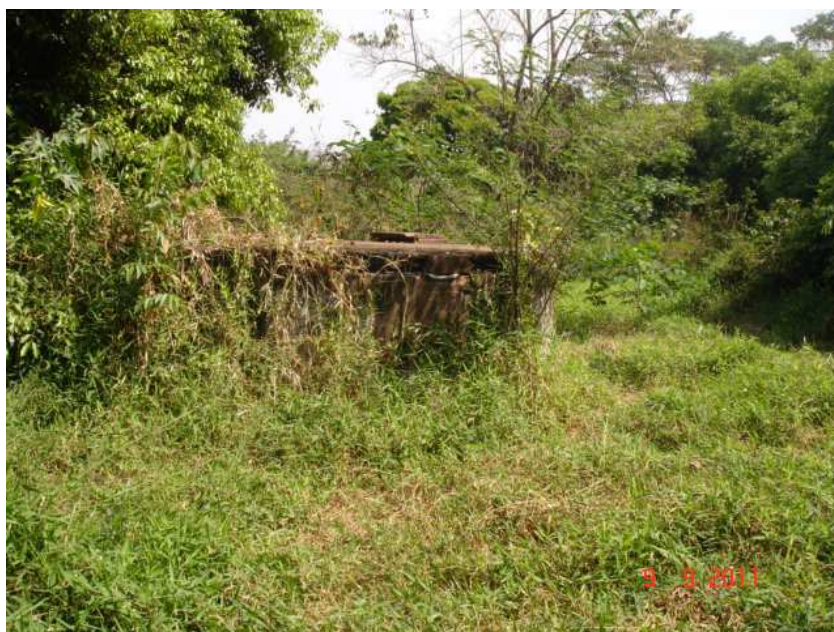
Figura 2.3. Captação por dreno (MOUT01).
