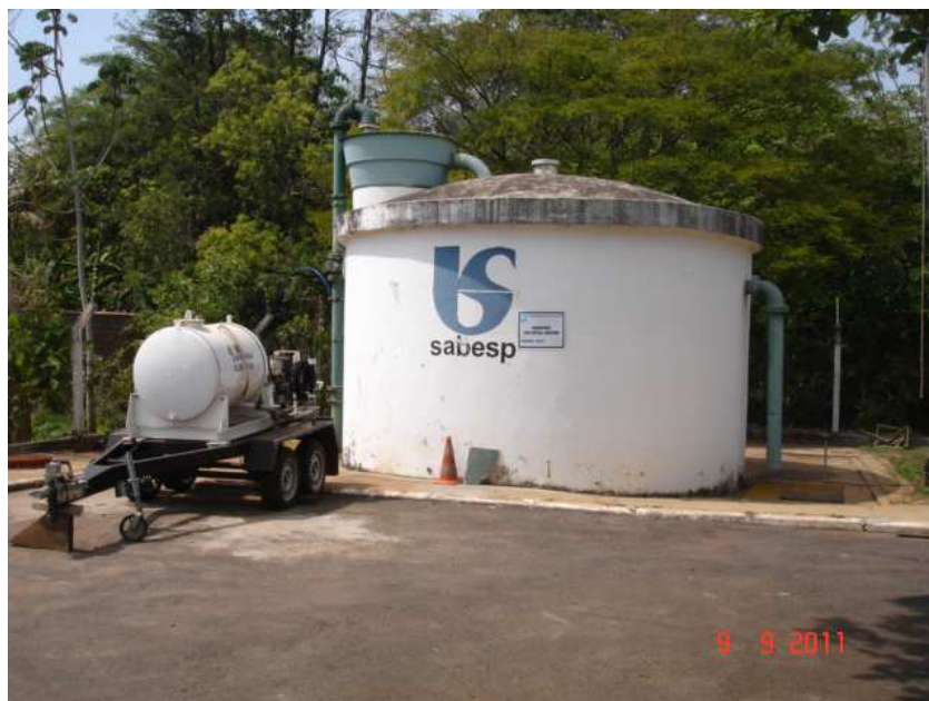
Figura 2.7. Reservatório apoiado (RA01).
