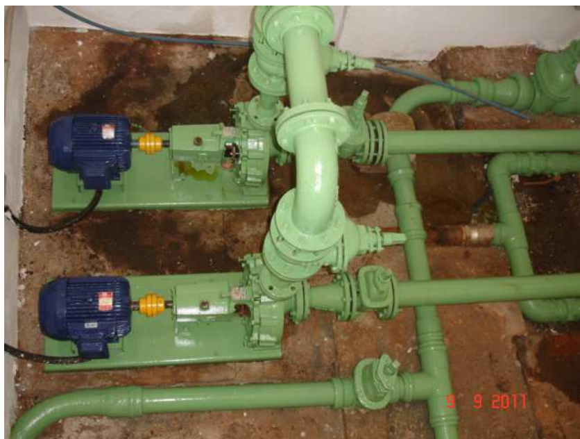
Figura 2.13. Estação elevatória de água tratada (EEAT02).
