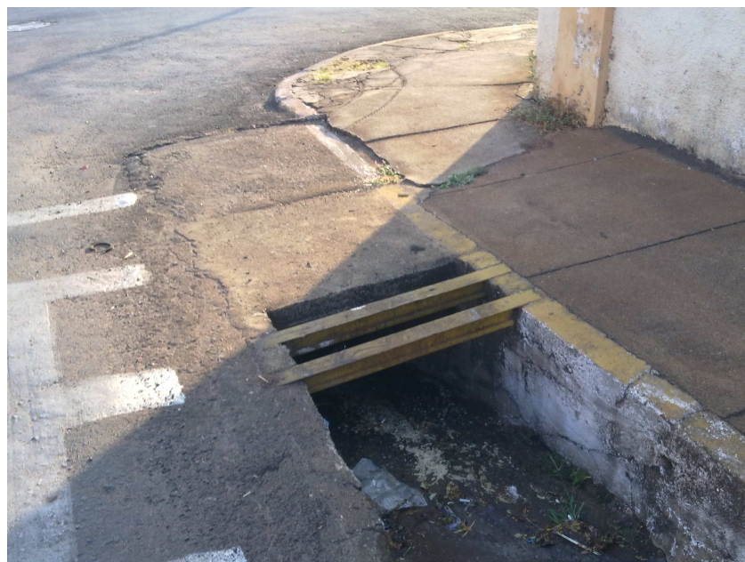
Figura 5.14. Bocas de Lobo de Grelhas – Esquina Ruas: Dona Laurinda E. Nascimento e Capitão Luiz Venâncio.
