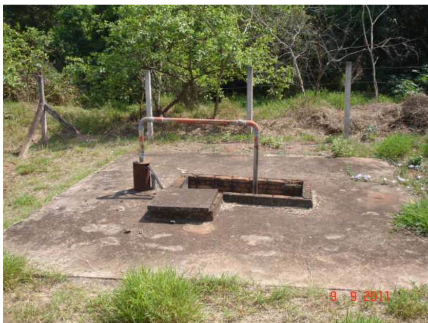
Figura 2.5. Poço profundo PPS06.
