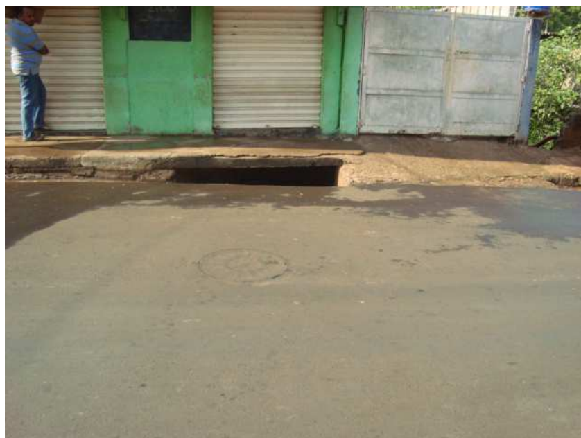
Figura 5.12. Boca de Lobo de Guia e Tampão de ferro do PV.
