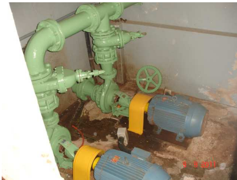
Figura 2.11. Estação elevatória de água tratada (EEAT01).
