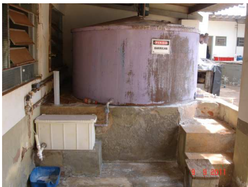
Figura 2.8. Tanque de preparo de barrilha.
