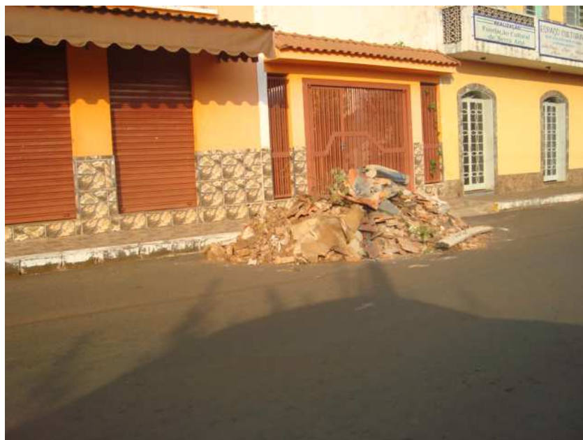
Figura 4.39. Amontoamento do entulho pelos moradores nas vias.
