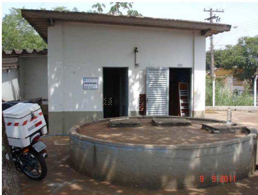
Figura 2.10. Estação elevatória de água tratada (EEAT01).
