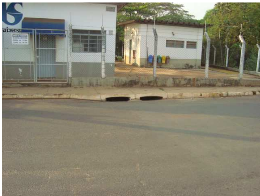
Figura 5.10. Boca de Lobo Dupla de Guia.
