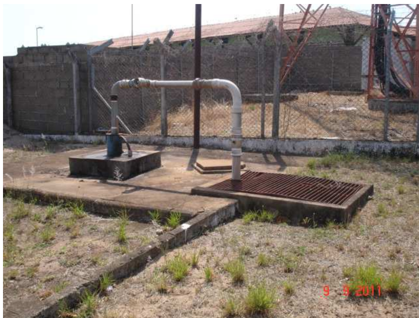
Figura 2.4. Poço profundo PPS05.
