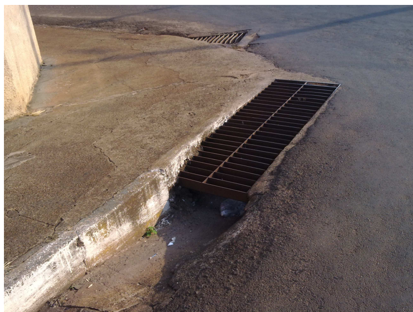
Figura 5.13. Bocas de Lobo de Grelhas – Esquina Ruas: Dona Laurinda E. Nascimento e Capitão Luiz Venâncio.
