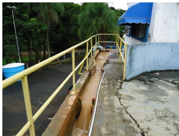
Foto 4.5 - Calha Parshall - Chegada da Água Bruta
