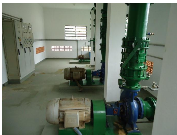
Foto 4.3 – Conjuntos Motobomba – EEAB 01
