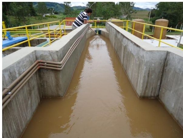
Foto 4.8 – Calha Parshall – Chegada da Água Bruta
