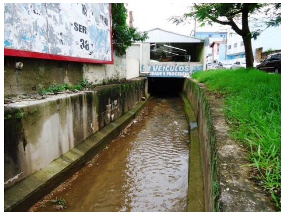
Foto 4.11 – Construções em cima do ribeirão na área urbana.
