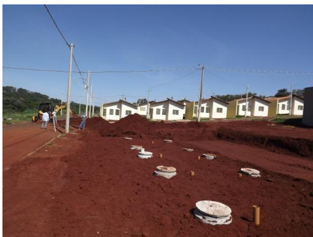
Foto 3.39 – ETE Condomínio Morada do Sol – Vista 1.
