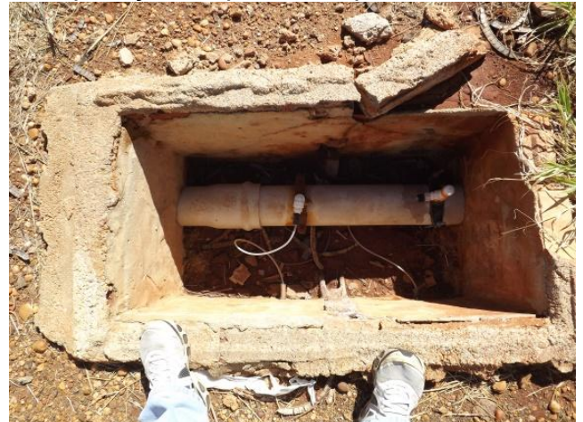
Foto 3.16 – Adutora do P7 Do Morro – Ponto de Aplicação.
