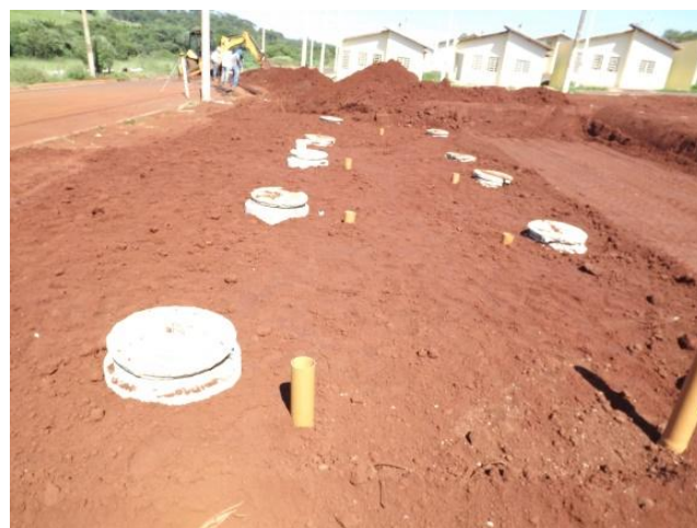
Foto 3.40 – ETE Condomínio Morada do Sol – Vista 2.
