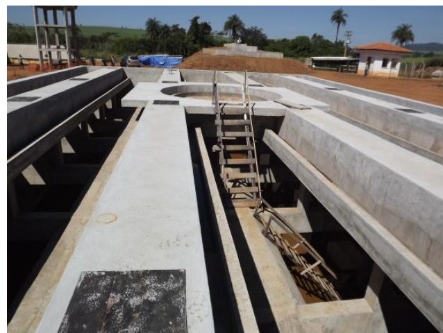
Foto 3.46 - Reatores Anaeróbios UASB.
