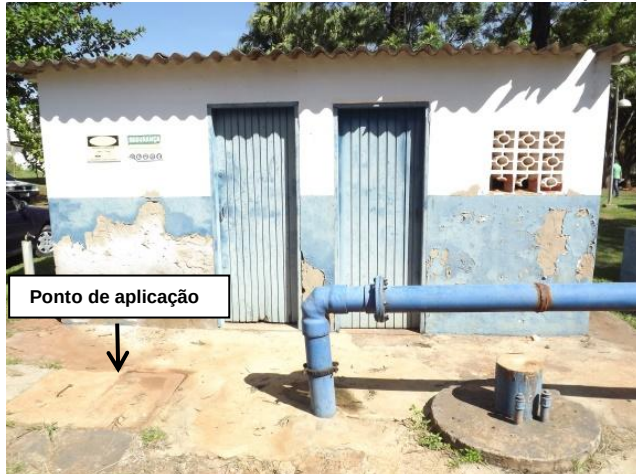
Foto 3.15 – Adutora do P6 Prefeitura – Ponto de Aplicação.
