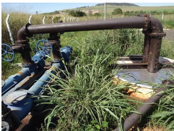
Foto 3.37 - Poço de Sucção e Tubulações da EEE Paranoá.
