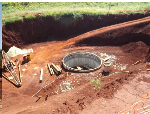
Foto 3.42 – EEE Rio de Janeiro – Vista 2.
