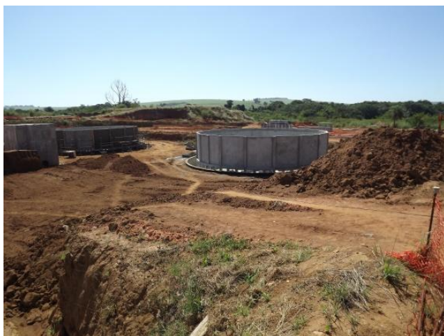
Foto 3.47 - Vista Geral dos Filtros Biológicos.
