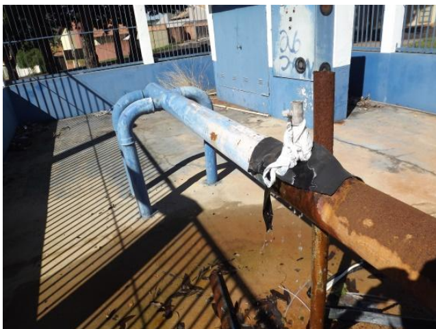
Foto 3.7 – P8 Dom Camilo – Destaque Vazamento na adutora.
