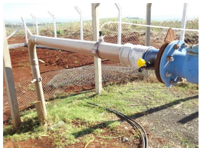
Foto 3.20 – Adutora do P17 Santa Luzia – Ponto de Aplicação.
