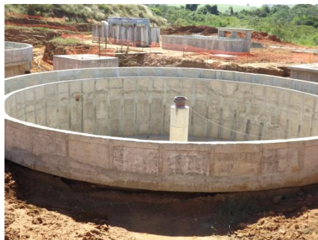
Foto 3.48 - Vista Geral de um Decantador.
