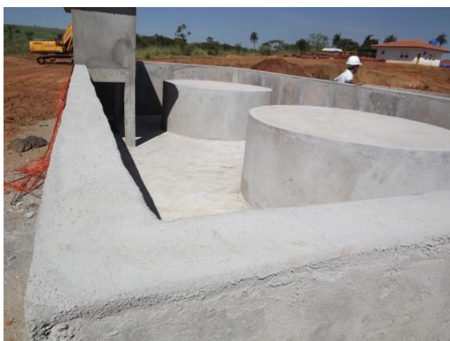
Foto 3.49 – Tanque de Armazenamento de Hipoclorito.
