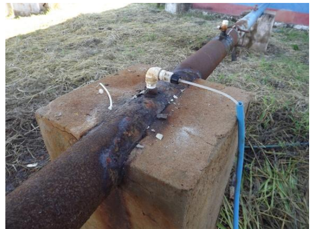
Foto 3.18– Adutora do P14 Santa Clara – Ponto de Aplicação.
