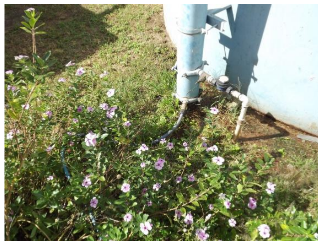
Foto 3.32 – Adutora da EEAT Prefeitura
