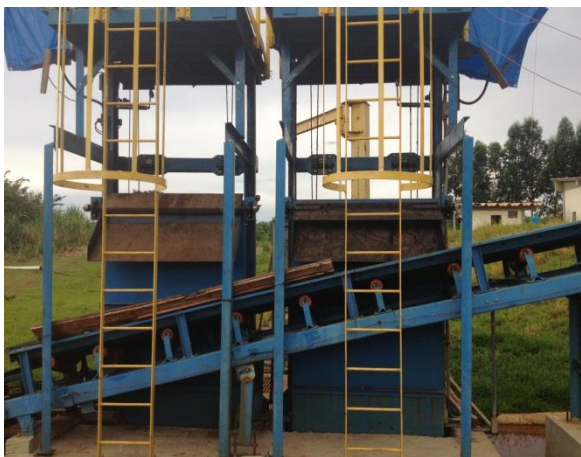
Foto 4.11 - Tratamento preliminar – gradeamento
