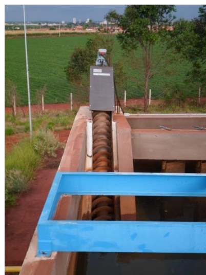
Foto 4.12 - Tratamento preliminar – caixa de areia
