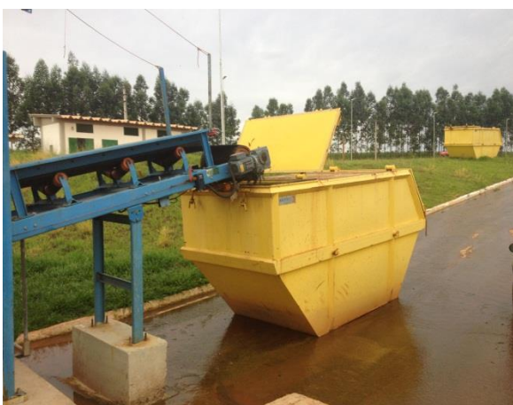
Foto 4.13 - Caçamba – sólidos do tratamento preliminar
