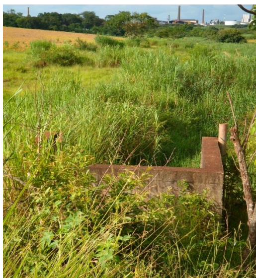
Foto 4.36 - Bacia de detenção – córrego Norte (I)
