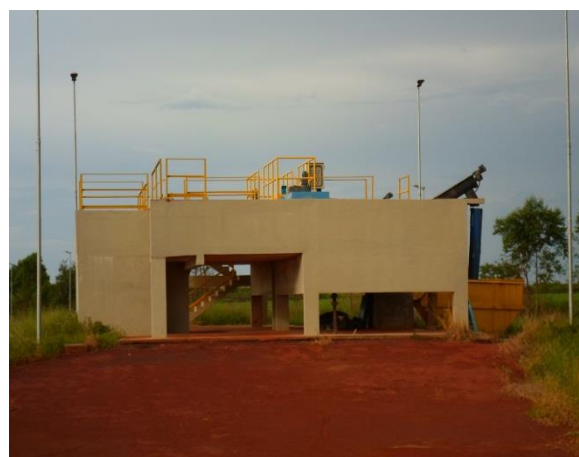
Foto 4.14 - Caixa de areia e decantador
