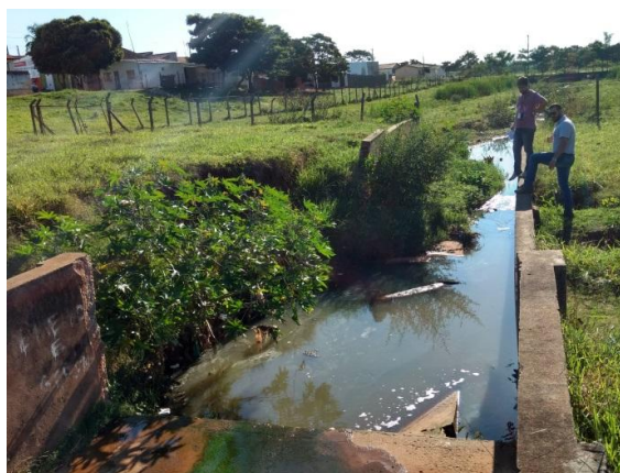
Foto 3.52 – Escada hidráulica – Vista do desmoronamento
