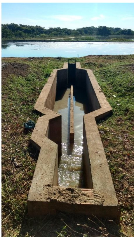
Foto 3.38 - Entrada ETE Pau d'Alho
