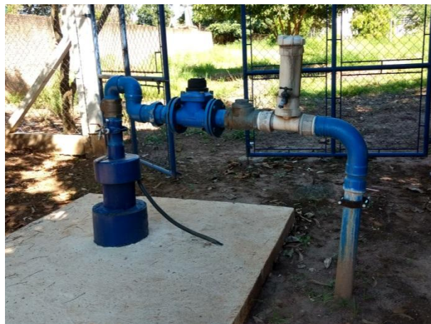
Foto 3.8 - Identificação do Poço: P11
