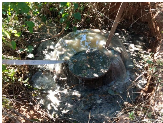
Foto 3.50 – PV transbordando e despejando esgoto na voçoroca
