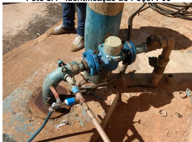
Foto 3.6 - Identificação do Poço: P08
