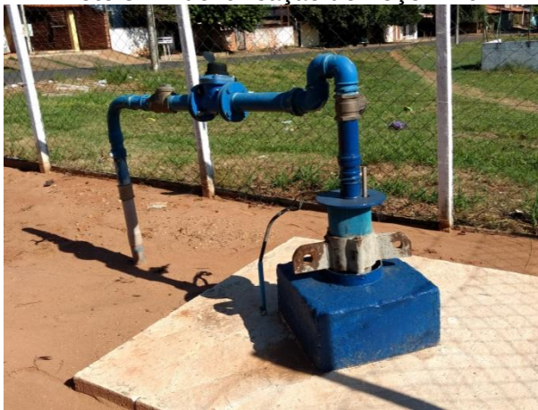
Foto 3.9 - Identificação do Poço: P12
