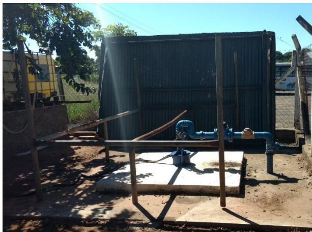
Foto 3.13 - Identificação do Poço: P16
