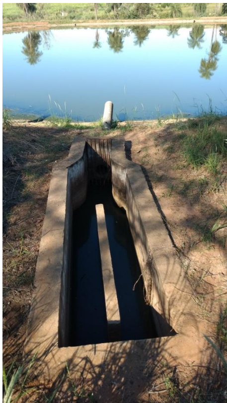
Foto 3.34 - Entrada ETE Baixão
