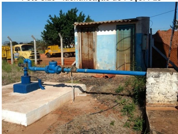
Foto 3.12 - Identificação do Poço: P15
