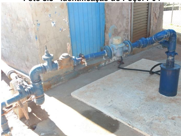
Foto 3.5 - Identificação do Poço: P07
