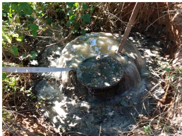
Foto 3.33 – PV transbordando e despejando esgoto na voçoroca
