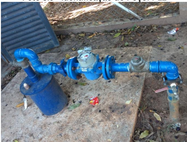
Foto 3.11 - Identificação do Poço: P14
