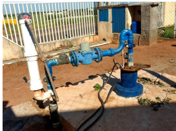
Foto 3.14 - Identificação do Poço: P17
