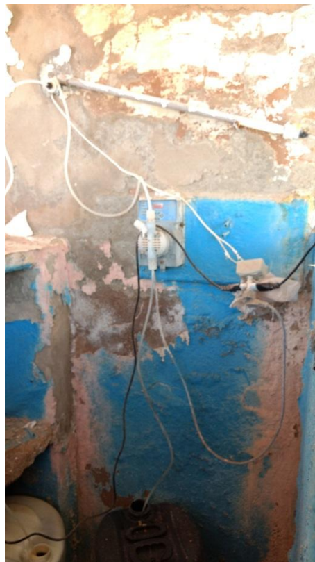
Foto 3.22 – Desinfecção no poço através de bomba dosadora
