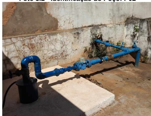
Foto 3.4 - Identificação do Poço: P06
