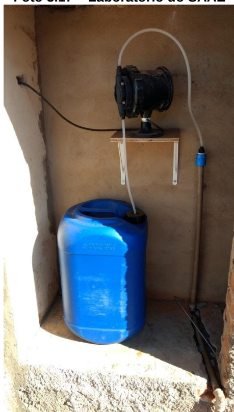
Foto 3.19 – Desinfecção no poço através de bomba dosadora
