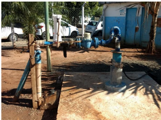
Foto 3.7 - Identificação do Poço: P10
