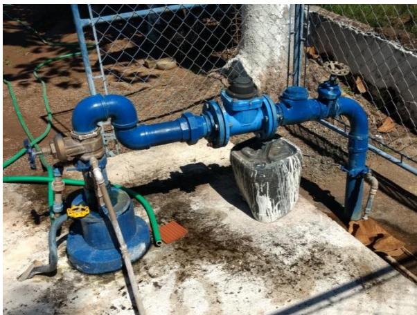
Foto 3.1 - Identificação do Poço: P01
