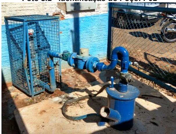
Foto 3.3 - Identificação do Poço: P04
