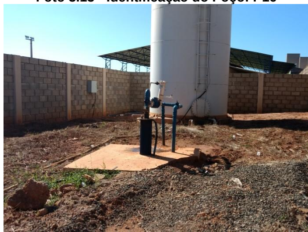
Foto 3.15 - Identificação do Poço: P18
