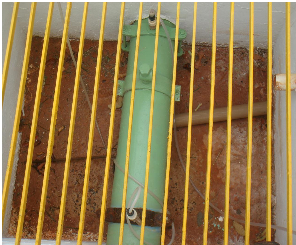
Figura 8. Tubulação de água desinfectada (verde claro), após sair da cabine.
