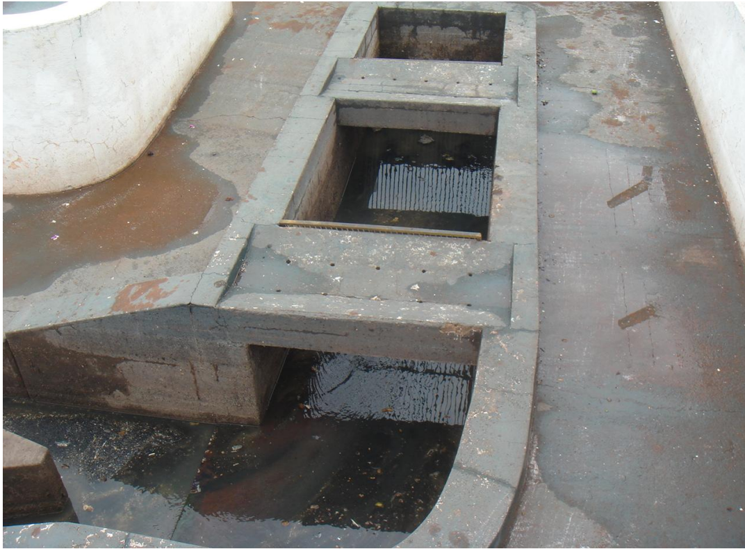
Figura 10. Etapa de gradeamento – Estação elevatória – bairro do CDHU.
