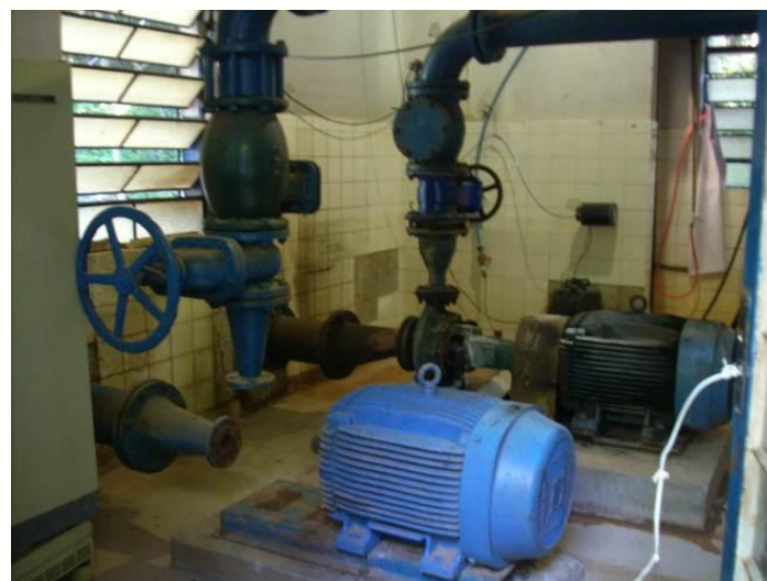
Figura 58 - Conjunto motor bomba captação Marcelo.
