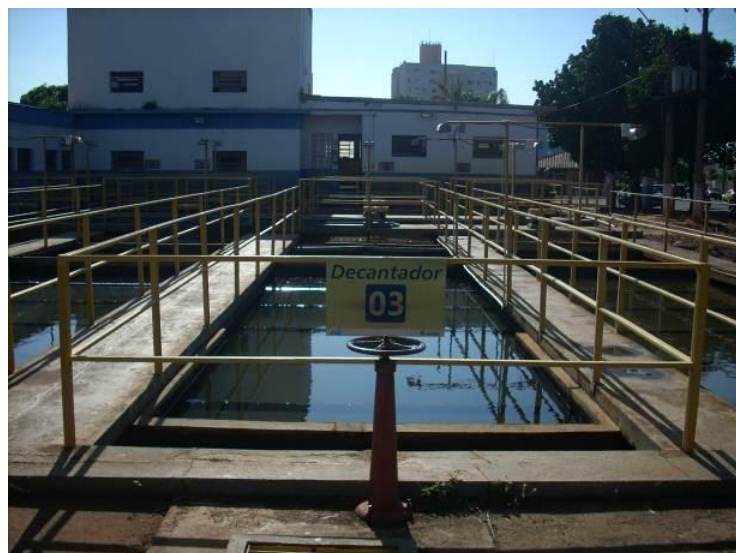
Figura 46 - Decantador 3 ETA I.
