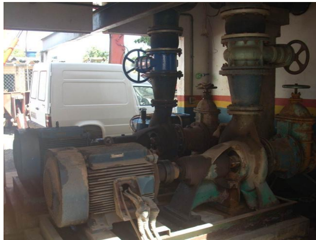
Figura 83 - Conjuntos motor bombas EEA San Martin.
