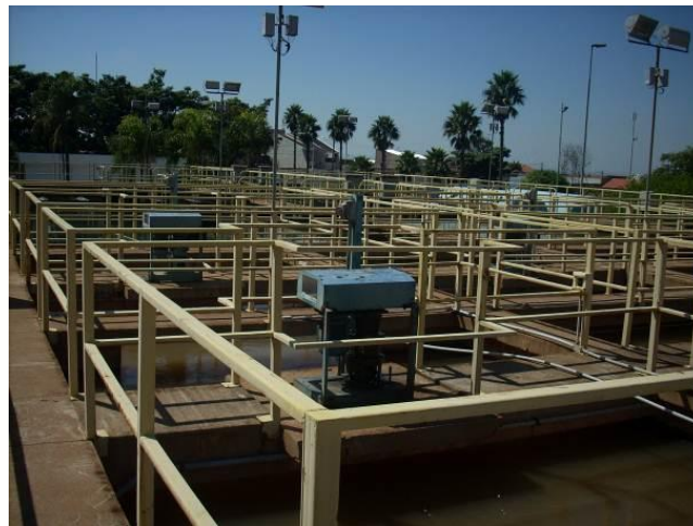
Figura 73 - Filtros ETA 2 – Módulo 1.
