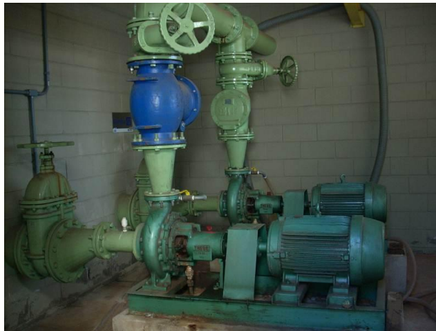
Figura 67 - Conjunto motor bomba recalque Ravagnane.
