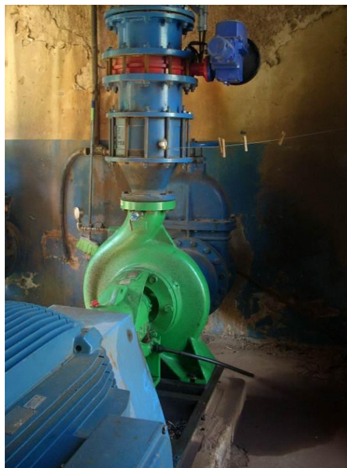
Figura 52 - Conjunto motor bomba Captação 2.
