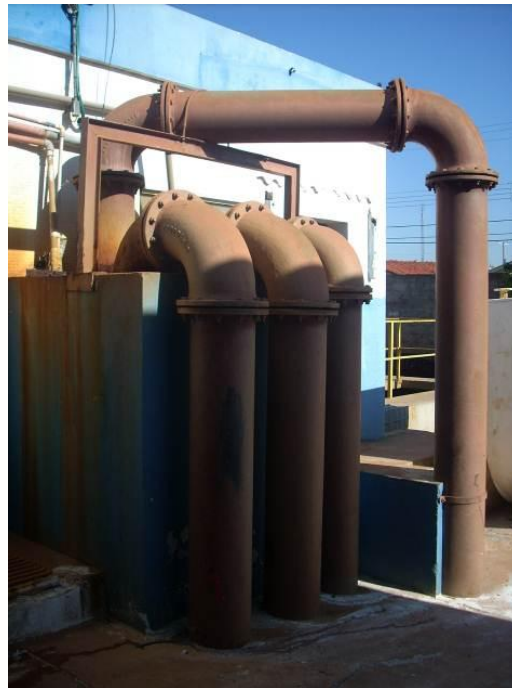
Figura 45 - Tubulação de chegada para tratamento.
