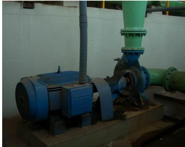
Figura 80 - Conjunto motor bomba San Martin.
