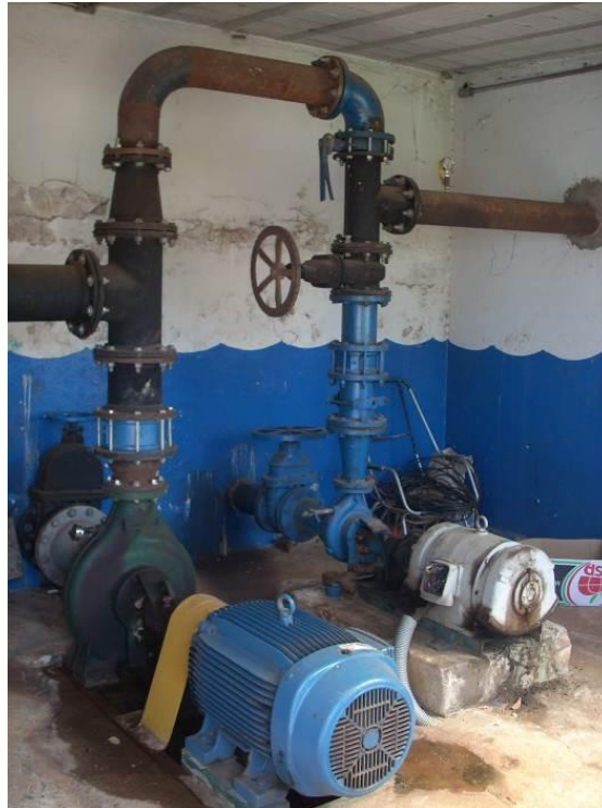
Figura 59 - Conjunto motor bomba Vila Carlota.
