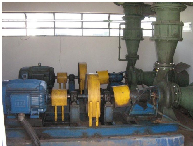
Figura 69 - Instalações e conjuntos motor bomba – João Paulo II.
