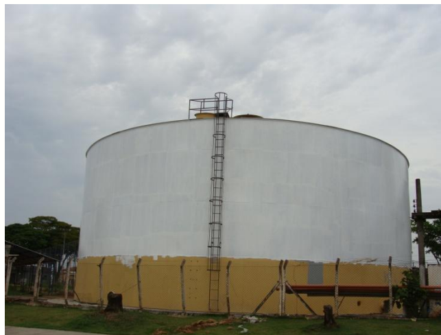
Figura 111 - Reservatório apoiado (metálico).
