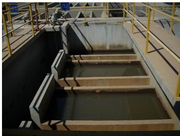
Figura 75 - Filtros ETA 2 – Módulo 2.
