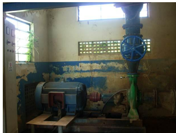
Figura 49 - Conjunto motor bomba Captação 1.
