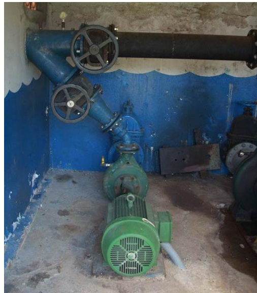
Figura 61 - Conjunto motor bomba Vila Carlota.
