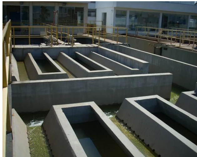
Figura 74 - Clarificadores ETA 2 – Módulo 2.
