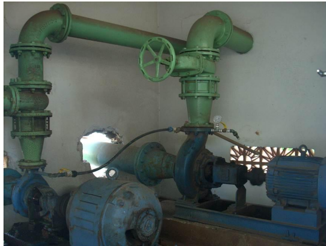
Figura 82 - Conjunto motor bomba EEAT Parque Itália.
