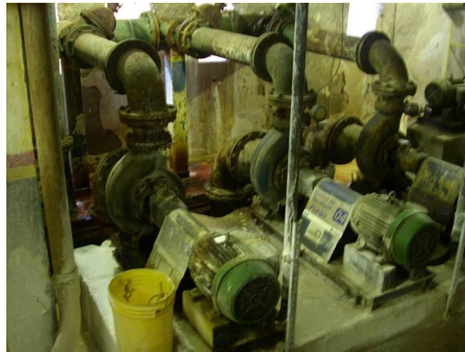
Figura 68 - Instalações e conjuntos motor bomba – Porão ETA 1.
