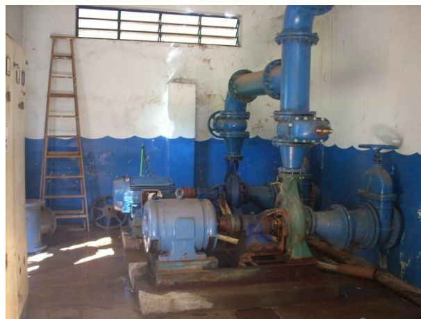
Figura 62 - Conjunto motor bomba Picerno.
