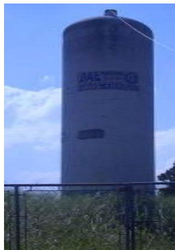
Figura 115 - Reservatório elevado em fibra.
