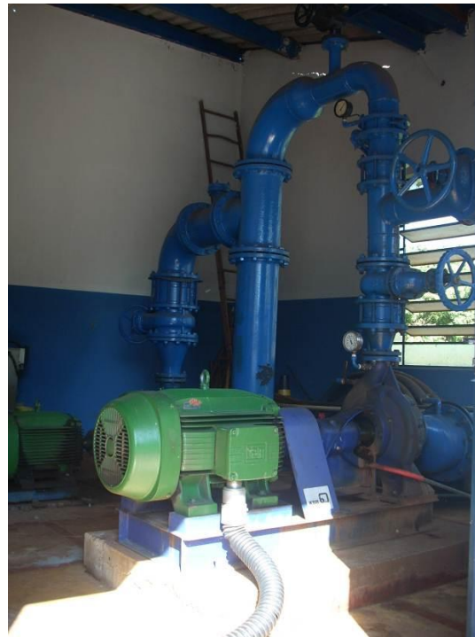
Figura 55 - Conjunto motor bomba – captação Marcelo.
