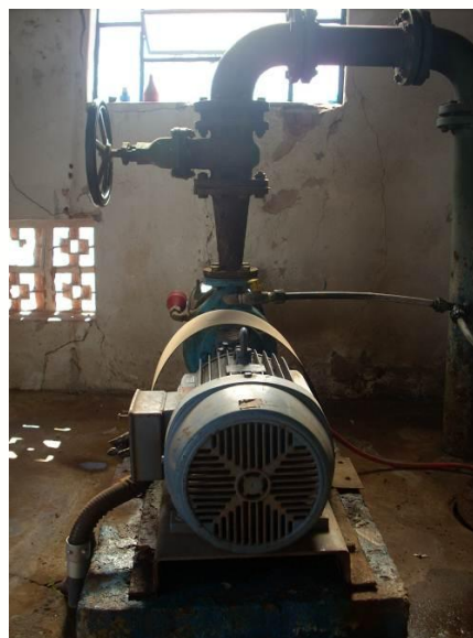
Figura 66 - Conjunto motor bomba 2 Planalto do Sol.
