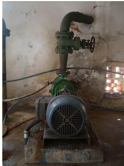
Figura 65 - Conjunto motor bomba 1 Planalto do Sol.
