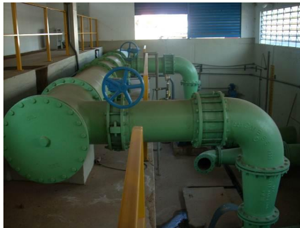
Figura 81 - Tubulação EEAT San Martin- Interna ETA 2.
