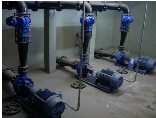
Figura 63 - Conjunto motor bomba Real Park.
