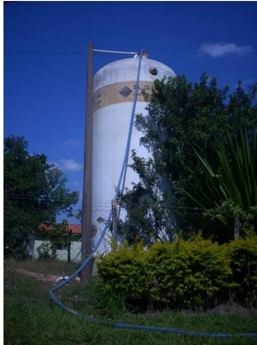
Figura 113 - Reservatório em fibra elevado.
