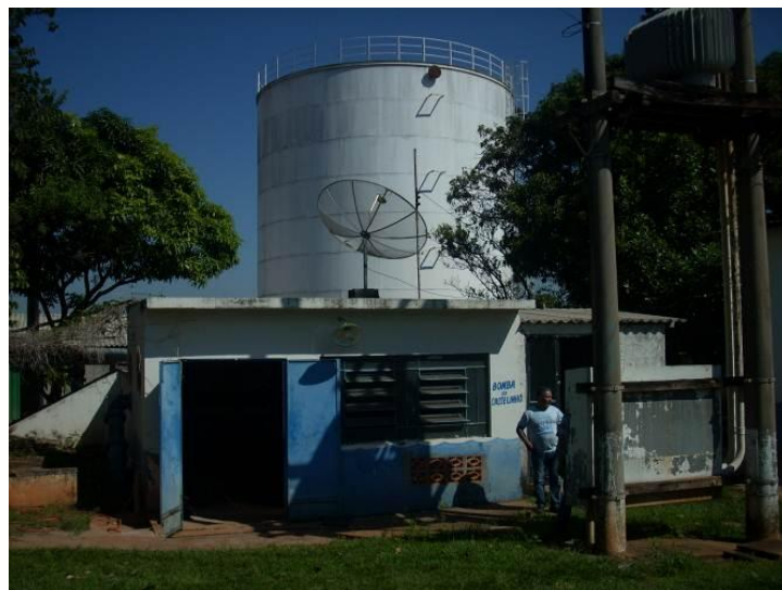
Figura 60 - Casa de bombas EEA Vila Carlota.
