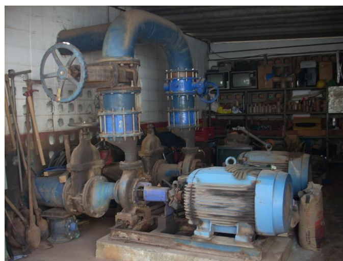
Figura 84 - Conjuntos motor bombas Jardim Calegari.
