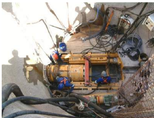
Figura 49 - Emboque Equipamento CT Jaguari
