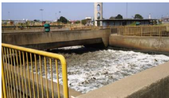
Figura 40 - Tanque de Aeração
