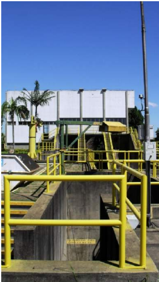
Figura 35 - Elevatória de Esgoto Final Fonte: Sabesp
