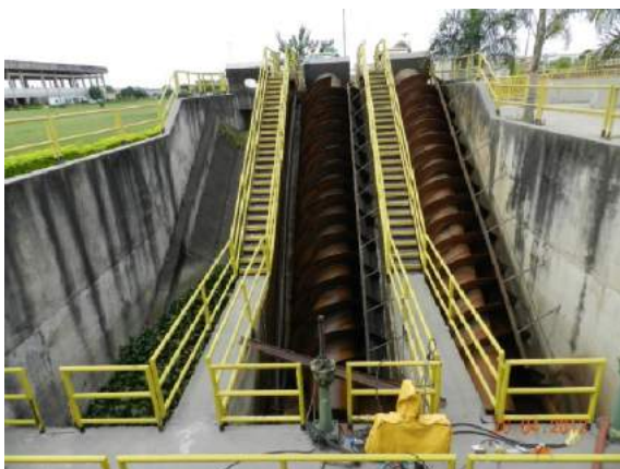
Figura 43 - Elevatória de recirculação de lodo
