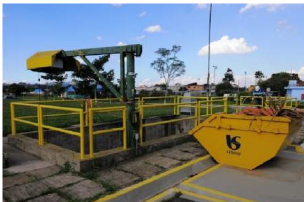
Figura 37 - Gradeamento fino Fonte: Sabesp
