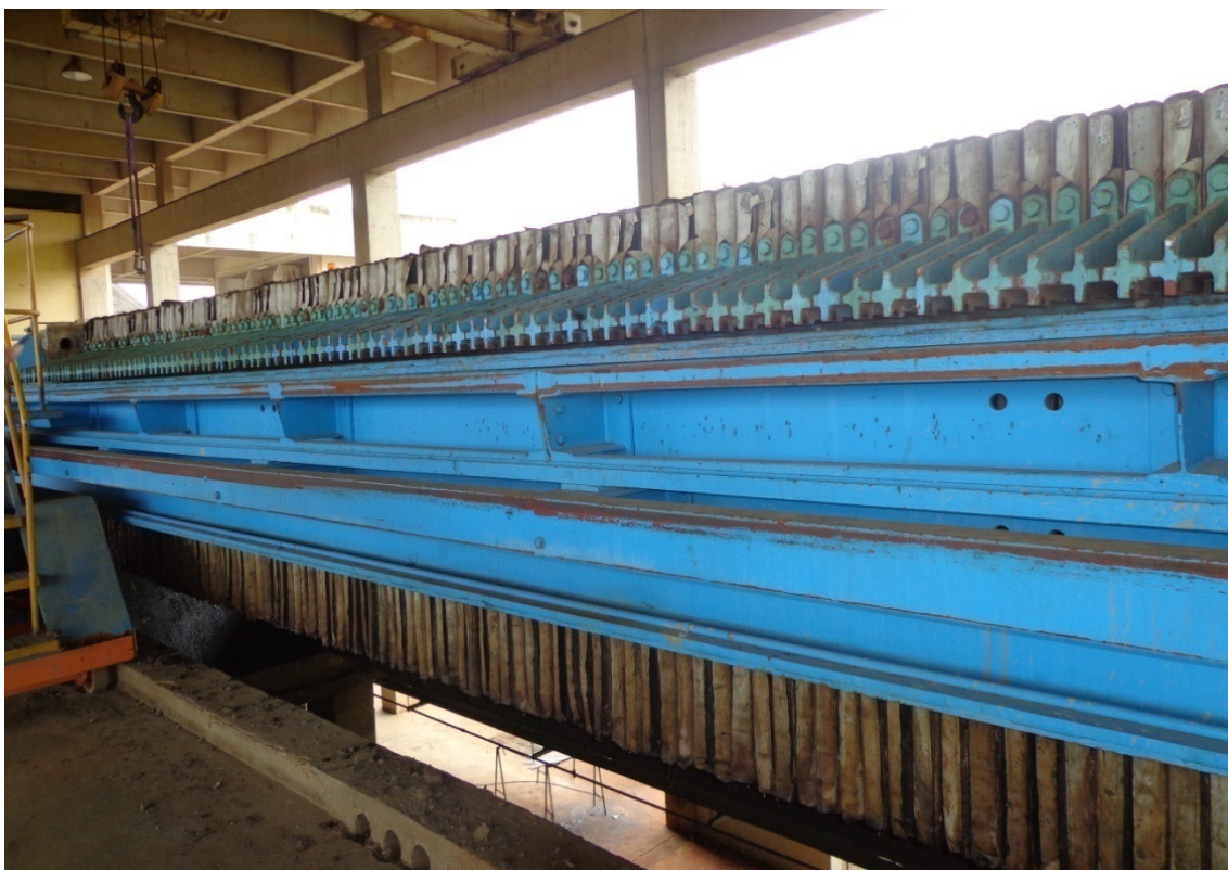
Figura 95 - Operação do sistema de prensa para desidratação do lodo. Fonte: SMMA, 2013.
