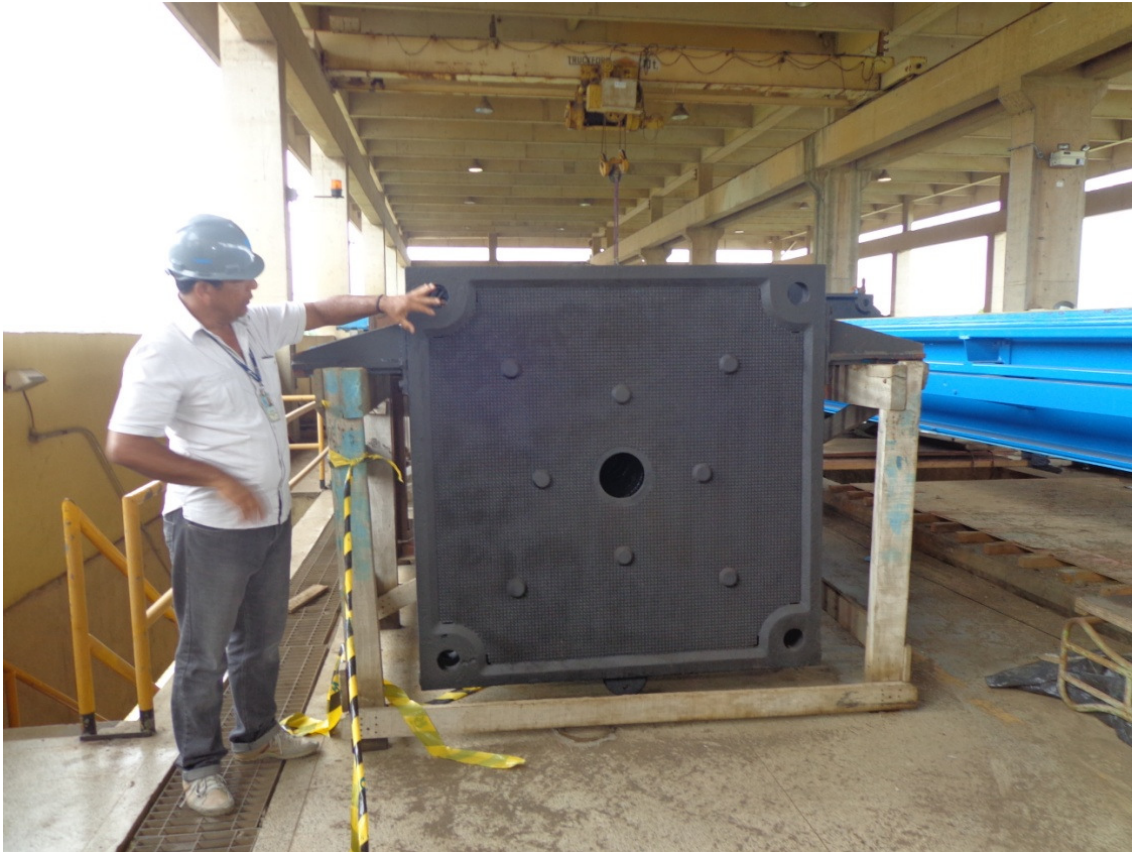
Figura 94 - Placa do sistema de prensa de lodos. Fonte: SMMA, 2013.
