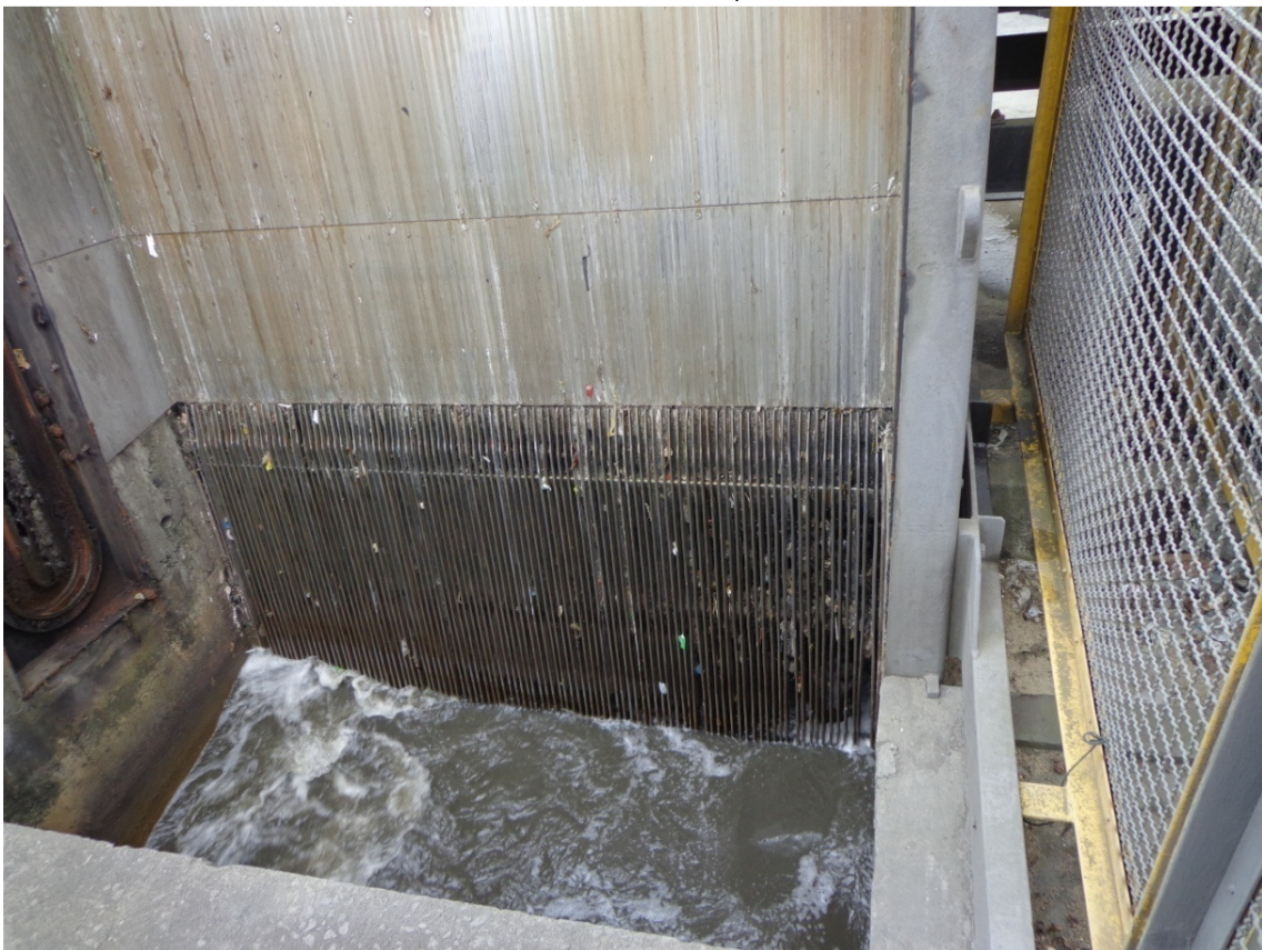
Figura 90 - Segundo gradeamento do processo de tratamento da ETE Suzano. Fonte: SMMA, 2013.
