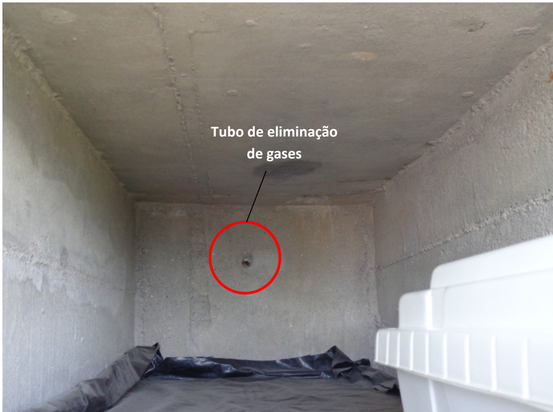
Figura 78 - Tubo de captação de gases instalado em lóculo do Memorial do Alto Tietê.
