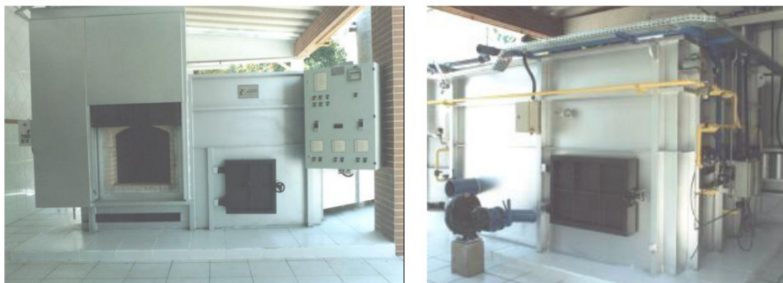
Figura 58- Unidade de tratamento e destinação de resíduos da Pioneira
