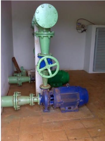
FOTO 4.6 – ESTAÇÃO ELEVATÓRIA DE ÁGUA BRUTA EEAB1
