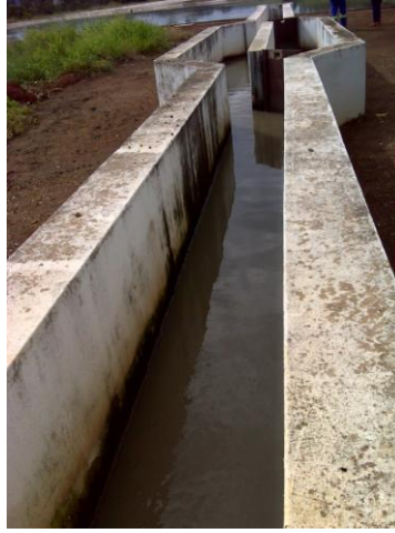
FOTO 4.20 – CAIXA DE AREIA DA ETE TAGUAÍ
