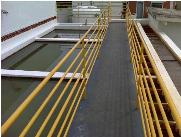
FOTO 4.10 – ESTAÇÃO DE TRATAMENTO DE ÁGUA ETA CONVENCIONAL
