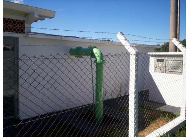
FOTO 4.14 - RESERVATÓRIO R2 APOIADO
