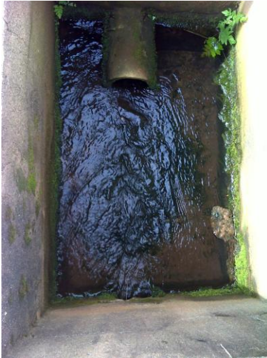
FOTO 4.2 – CAPTAÇÃO SUPERFICIAL PROVENIENTE DO DRENO 1
