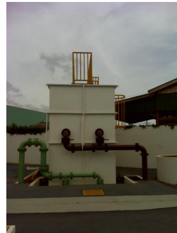
FOTO 4.11 – ESTAÇÃO DE TRATAMENTO DE ÁGUA – ETA METÁLICA
