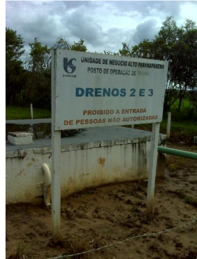
FOTO 4.3 – DRENOS 2 E 3 PARA CAPTAÇÃO DE ÁGUA SUPERFICIAL
