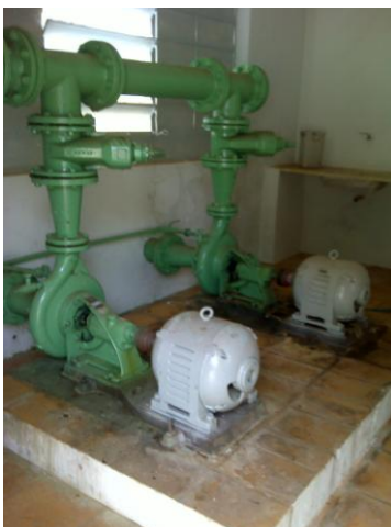
FOTO 4.8 – ESTAÇÃO ELEVATÓRIA DE ÁGUA BRUTA EEAB P1
