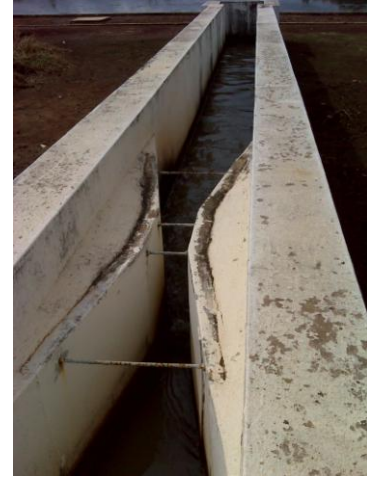
FOTO 4.21 – CALHA PARSHALL DA ETE TAGUAÍ
