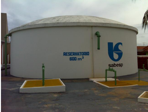
FOTO 4.13 - RESERVATÓRIO R1 APOIADO
