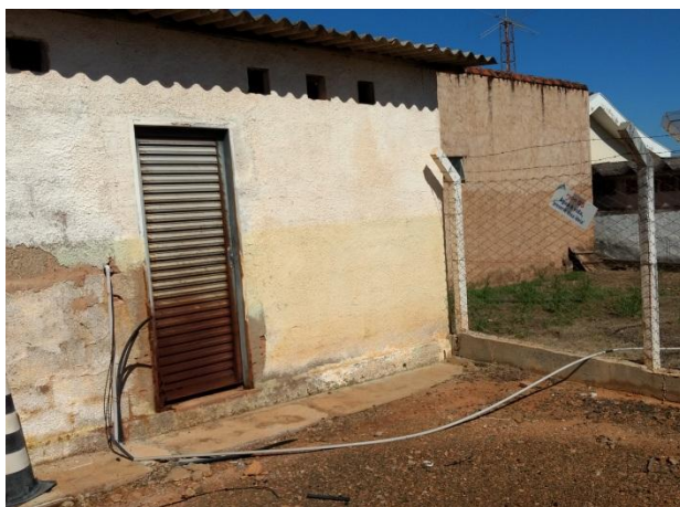
Foto 3.18 – Unidade de tratamento do Poço 05
