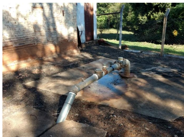
Foto 3.2 - Identificação do Poço: Poço 01
