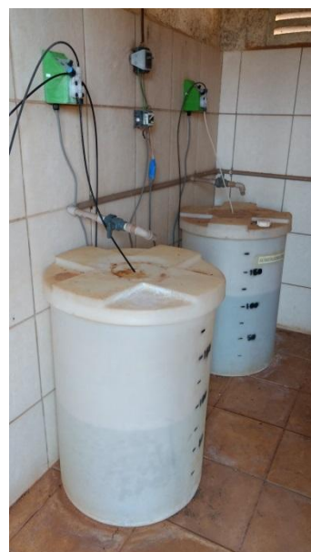
Foto 3.15 - Unidade de tratamento do Poço 02
