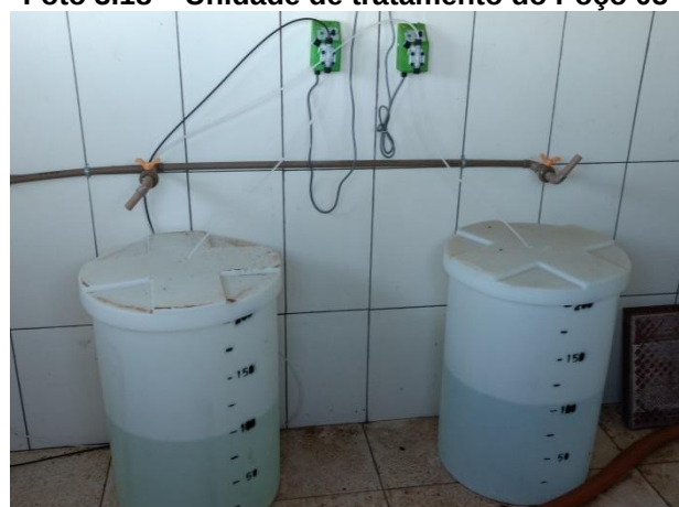
Foto 3.20 – Unidade de tratamento do Poço F.S.
