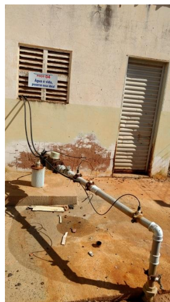
Foto 3.17 - Unidade de tratamento do Poço 04
