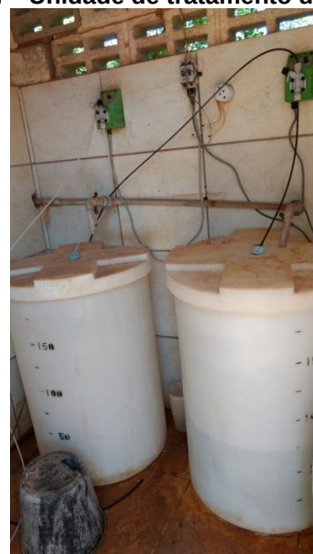
Foto 3.19 - Unidade de tratamento do Poço 06
