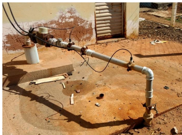
Foto 3.8 - Identificação do Poço: Poço 04
