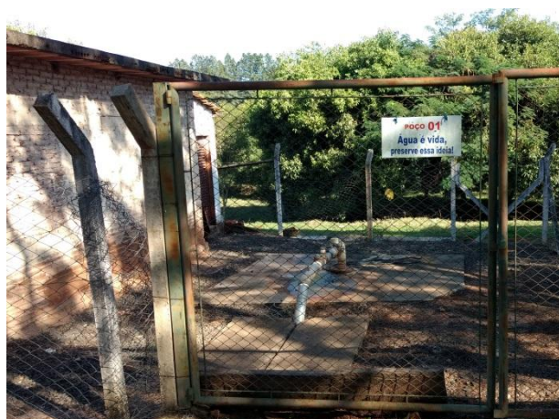
Foto 3.14 – Unidade de tratamento do Poço 01
