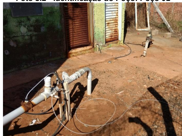
Foto 3.4 - Identificação do Poço: Poço 03 (1 e 2)
