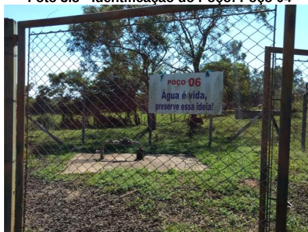
Foto 3.10 - Identificação do Poço: Poço 06
