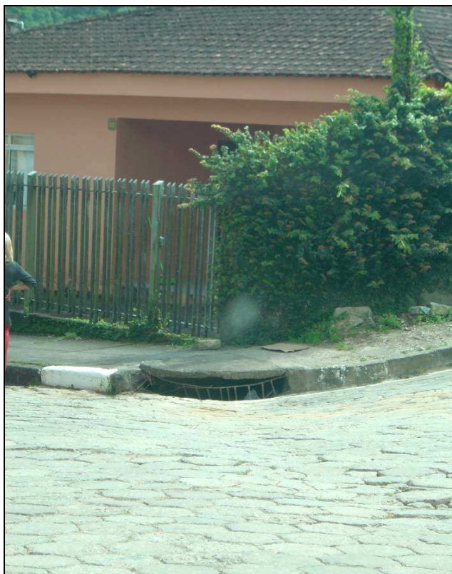
Foto 2 – Situação de Boca-de-lobo em Rua de Tapiraí
