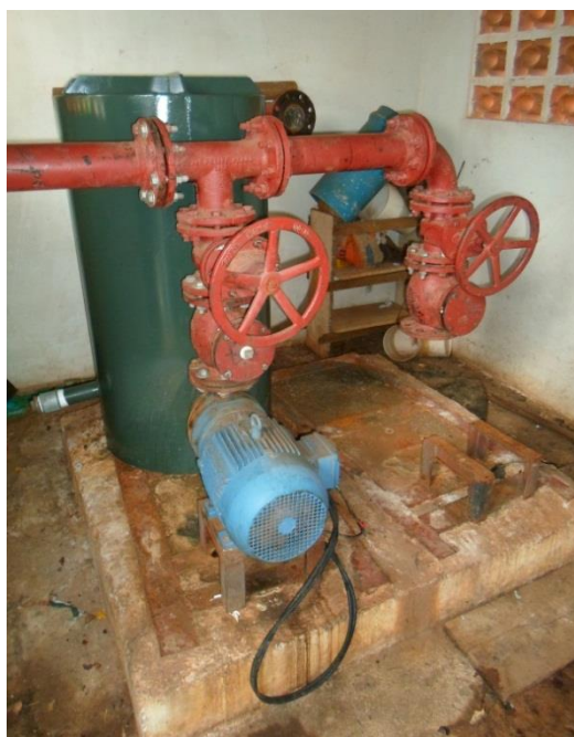
Foto 4.8 - Estação elevatória de esgoto
