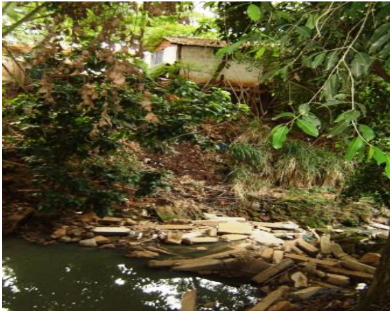
Foto 51- Erosão ao lado de residência.
