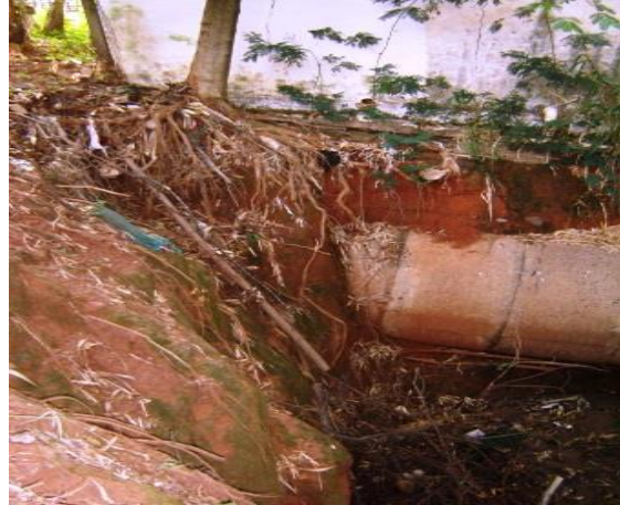
Foto 50– Tubulação de captação descalçada.
