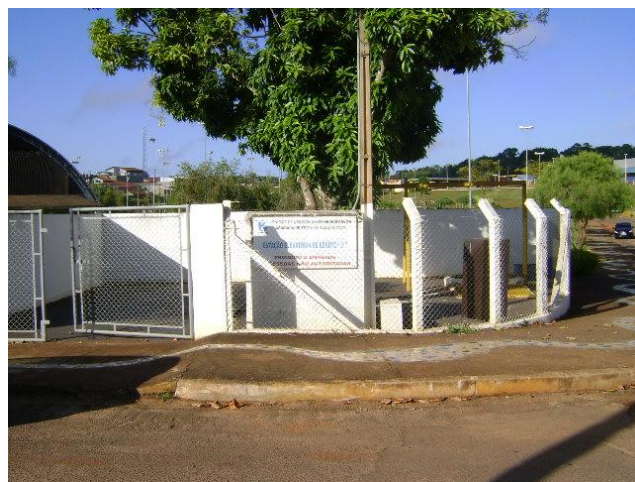
FOTO 4.13 – EEE 2 DO SISTEMA SEDE
