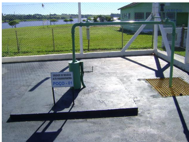
FOTO 4.9 – POÇO PROFUNDO PORTO TAQUARI
