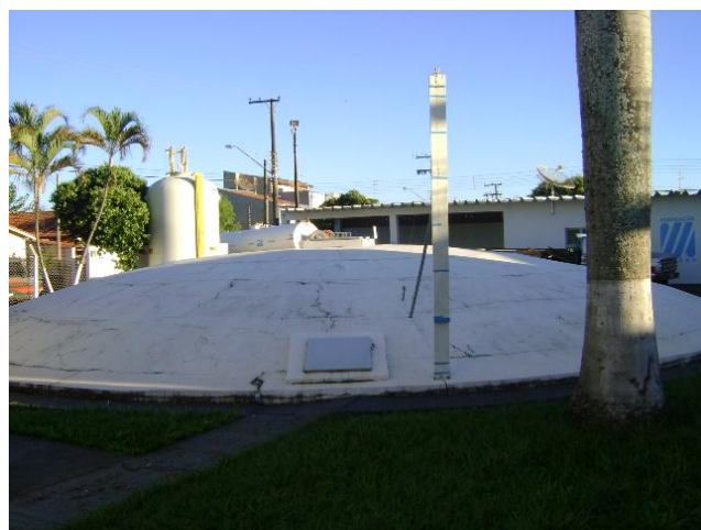
FOTO 4.7 - RESERVATÓRIO SEMI ENTERRADO R2 – LOCALIZADO NA ETA TAQUARITUBA
