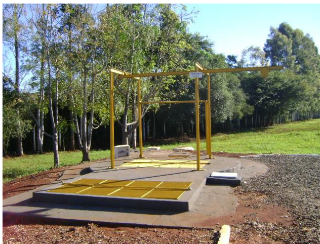
FOTO 4.16 – EEE4 FINAL DO SISTEMA SEDE
