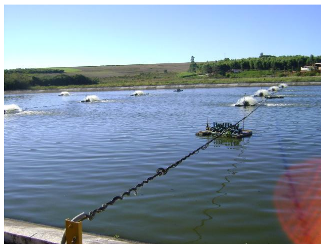
FOTO 4.20 – LAGOA FACULTATIVA AERADA B COM AERADORES SUPERFICIAIS
