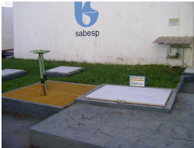
FOTO 4.4 – ESTAÇÃO ELEVATÓRIA DE ÁGUA TRATADA EEAT1
