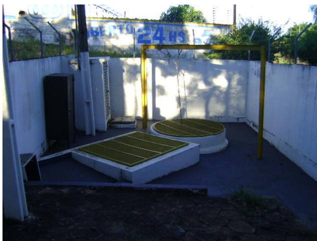
FOTO 4.12 – EEE 1 DO SISTEMA SEDE
