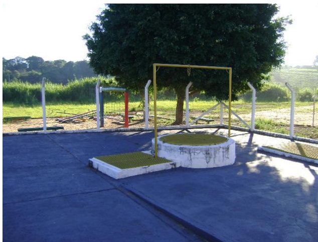
FOTO 4.14 – EEE3 DO SISTEMA SEDE
