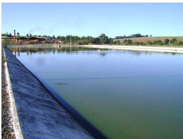
FOTO 4.19 – LAGOA FACULTATIVA AERADA A COM AERADORES SUBMERSÍVEIS
