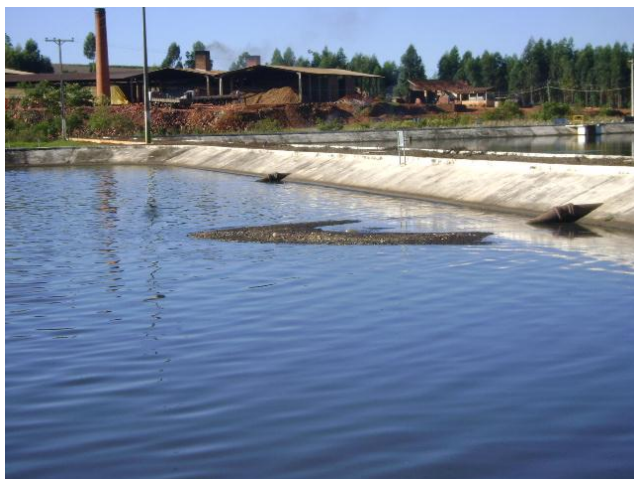
FOTO 4.21 – PROBLEMA DE ASSOREAMENTO NAS LAGOAS DA ETE
