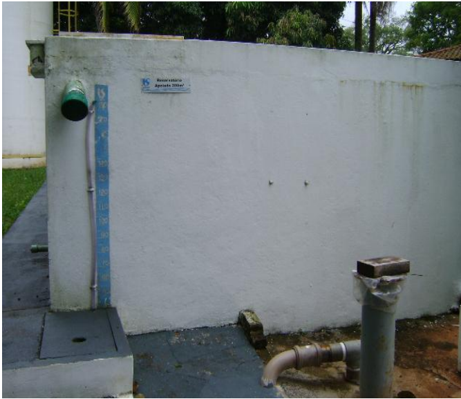
FOTO 4.5 - RESERVATÓRIO R2 - 200M 3
