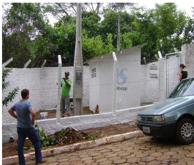
FOTO 4.4 - VISTA DO BOOSTER CEMITÉRIO
