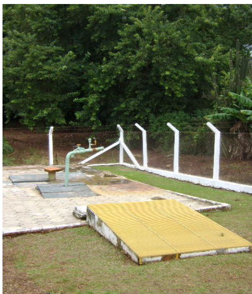
FOTO 4.1 VISTA DO POÇO PROFUNDO P5 DE TIMBURI
