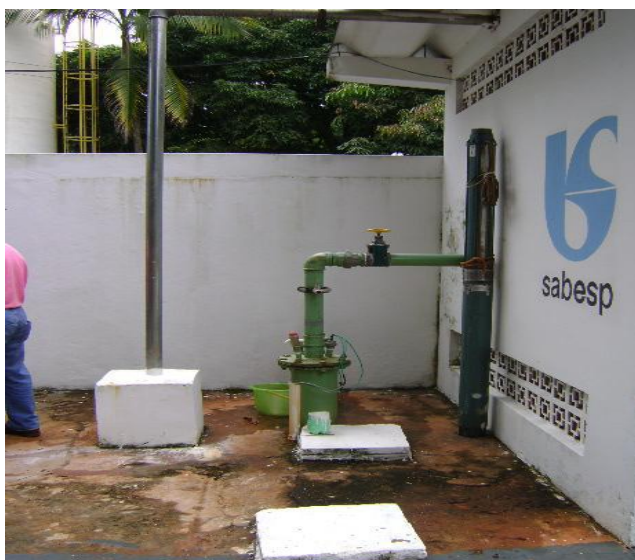
FOTO 4.3 VISTA DO BOOSTER ZONA ALTA
