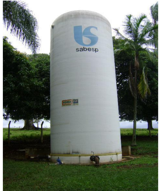
FOTO 4.6 - RESERVATÓRIO R1 – 100 M 3
