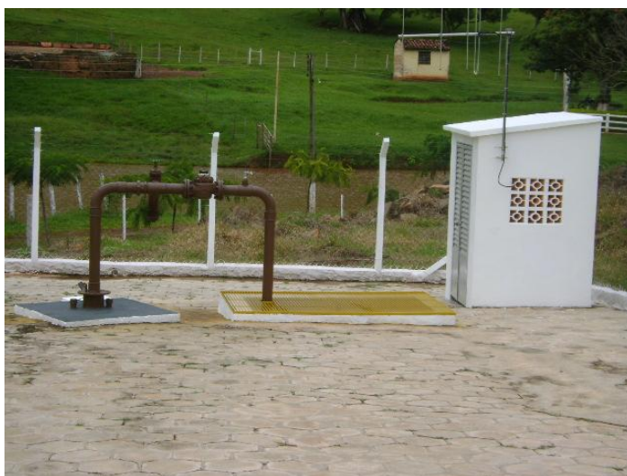
FOTO 4.2 – VISTA DO POÇO PROFUNDO P6 DE TIMBURI
