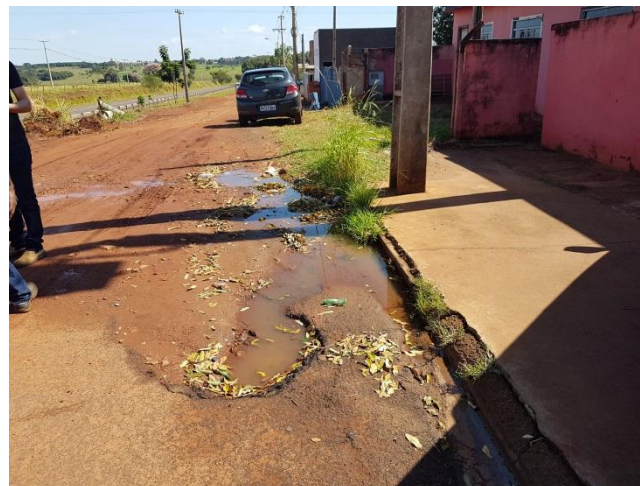
Foto 3.16 – Carreamento de Areia e Asfalto pela alta velocidade do escoamento superficial
