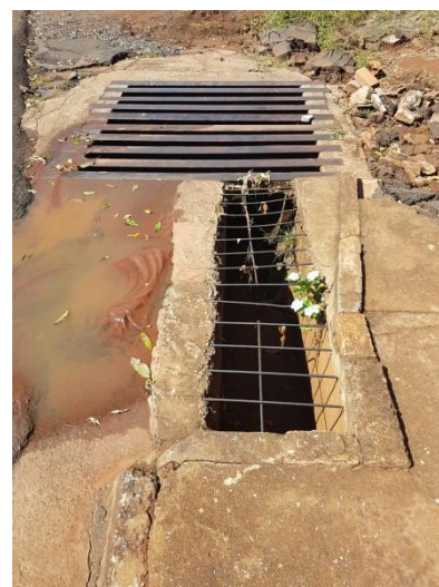
Foto 3.6 - Equipamentos de microdrenagem insuficientes na Rua São Paulo de Piratininga
