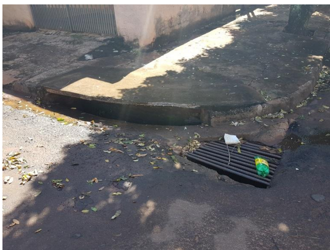
Foto 3.5 – Equipamentos de microdrenagem insuficientes na Rua São Paulo de Piratininga
