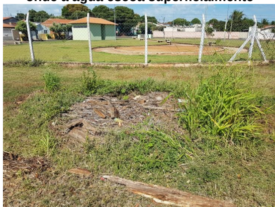
Foto 3.3 – Caixa de Passagem de Água Pluvial Estrangulada na Praça do Final da Avenida José Claudio Fogaça
