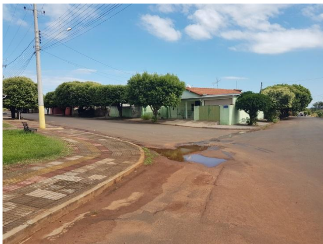
Foto 3.7 – Alagamento Estrada da Alegria por Falta de Estrutura de Microdrenagem
