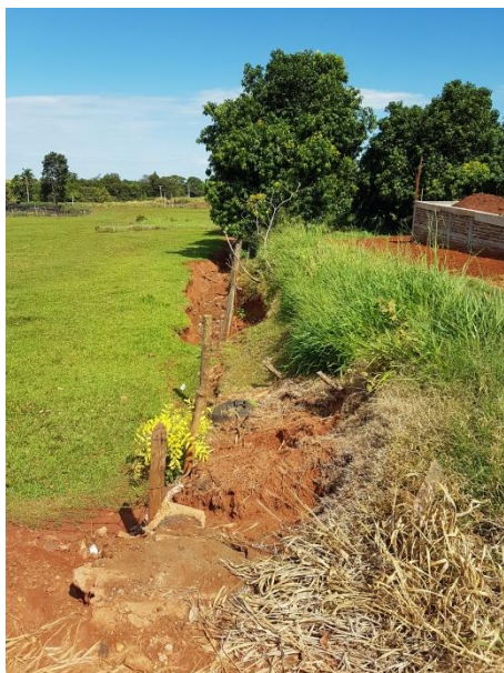
Foto 3.17 – Erosão na propriedade causada pela alta velocidade de escoamento superficial
