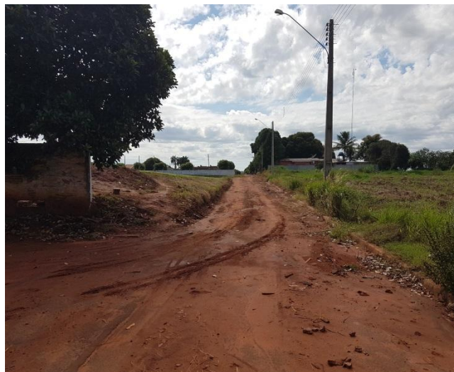
Foto 3.18 – Carreamento de Areia pela alta velocidade do escoamento superficial
