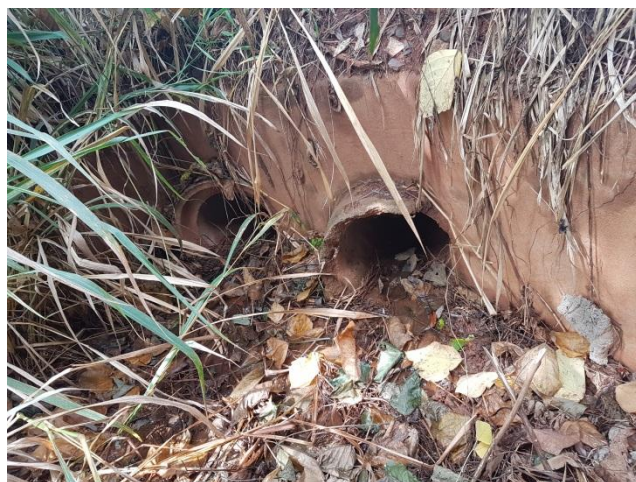
Foto 3.8 – GAP subdimensionada, com necessidade de limpeza e manutenção
