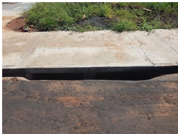
Foto 3.14 - Bocas de Lobo Subdimensionadas
