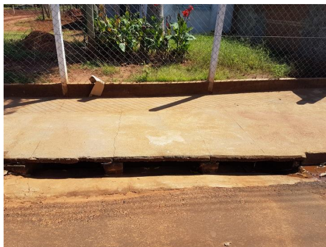
Foto 3.11 - Bocas de Lobo Subdimensionadas e com necessidade de manutenção
