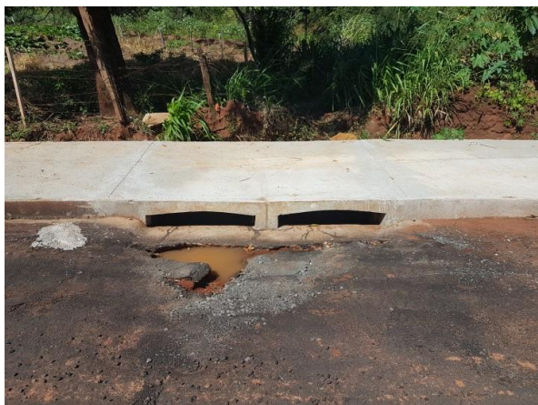
Foto 3.13 – Bocas de Lobo Subdimensionadas
