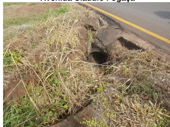
Foto 3.4 – GAP com necessidade de limpeza e manutenção
