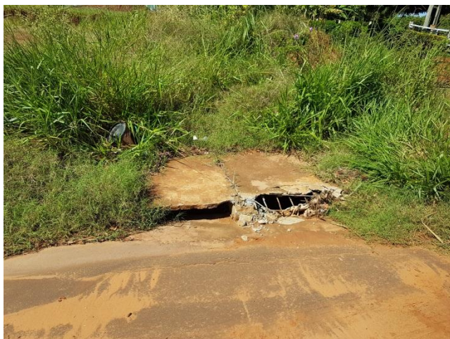
Foto 3.10 – Bocas de Lobo Subdimensionadas e com necessidade de manutenção
