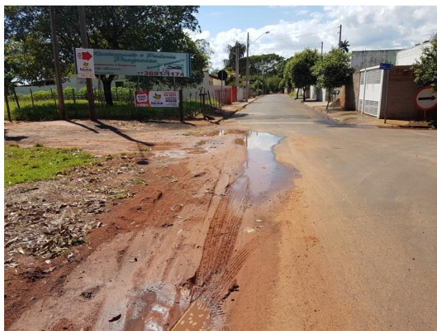
Foto 3.12 – GAP entupida, com necessidade de manutenção
