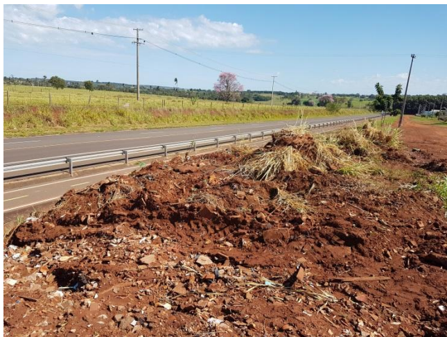
Foto 3.15 – Erosão na marginal à Via João Egídio
