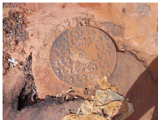
Foto 3.2 – PV de águas pluviais da galeria na Rua Sergipe
