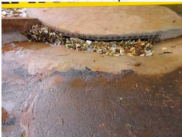
Foto 3.9 – Boca de lobo entupida no ponto de alagamento entre a Rua Bahia e a Rua São José
