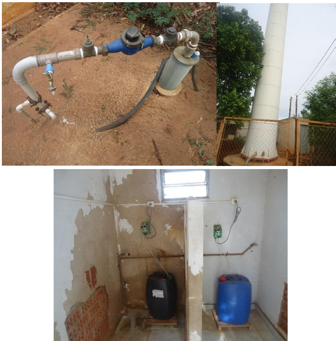
Imagem 9.3: P-02, respectivo reservatório e casa de cloro e flúor.
