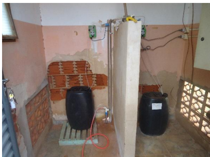
Imagem 9.5: P-04, respectivo reservatório e casa de cloro e flúor.
