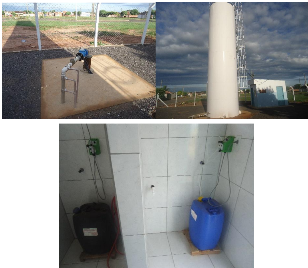
Imagem 9.8: P-07, respectivo reservatório e casa de cloro e flúor.
