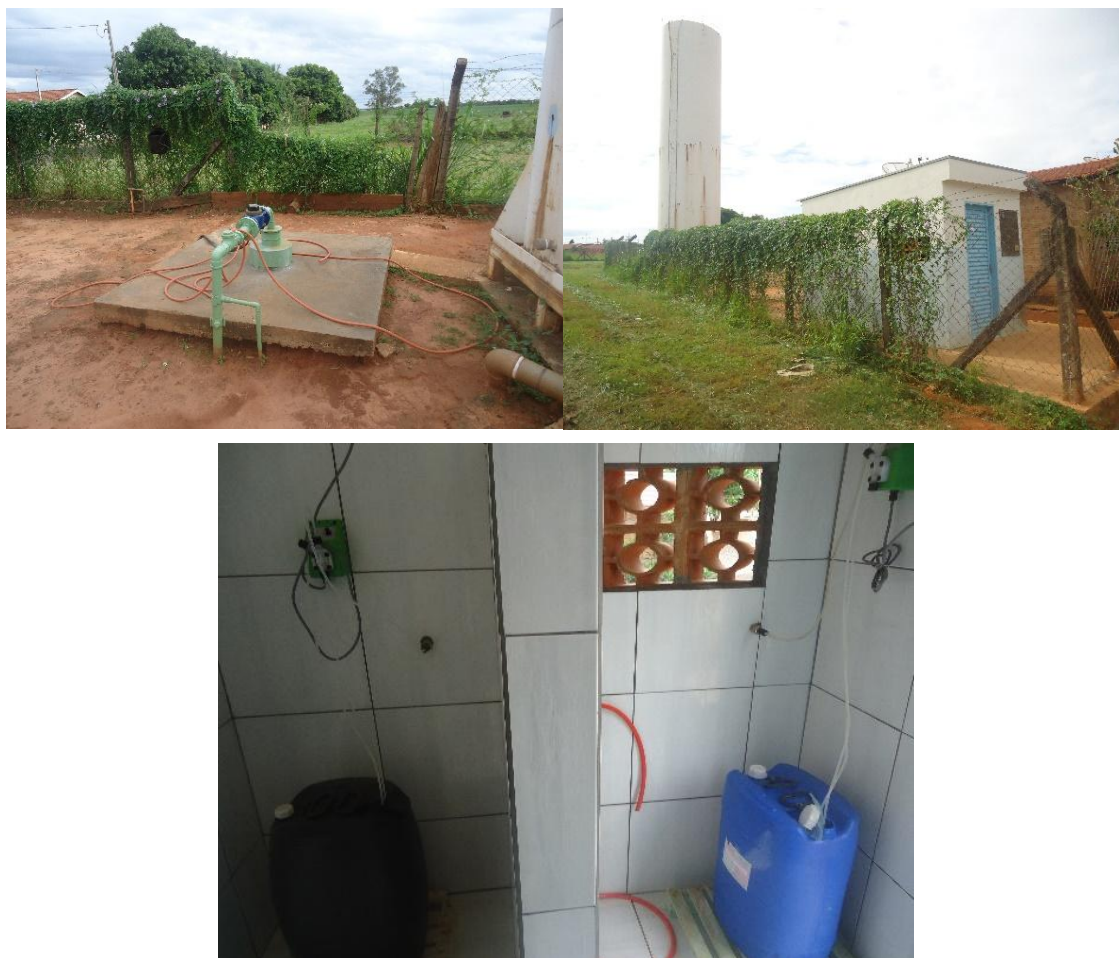
Imagem 9.4: P-03, respectivo reservatório e casa de cloro e flúor.
