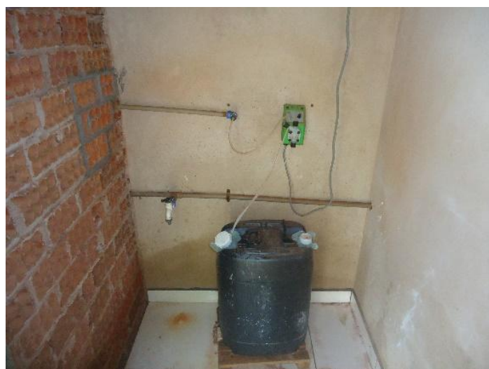
Imagem 9.7: P-06, respectivo reservatório e casa de cloro e flúor.
