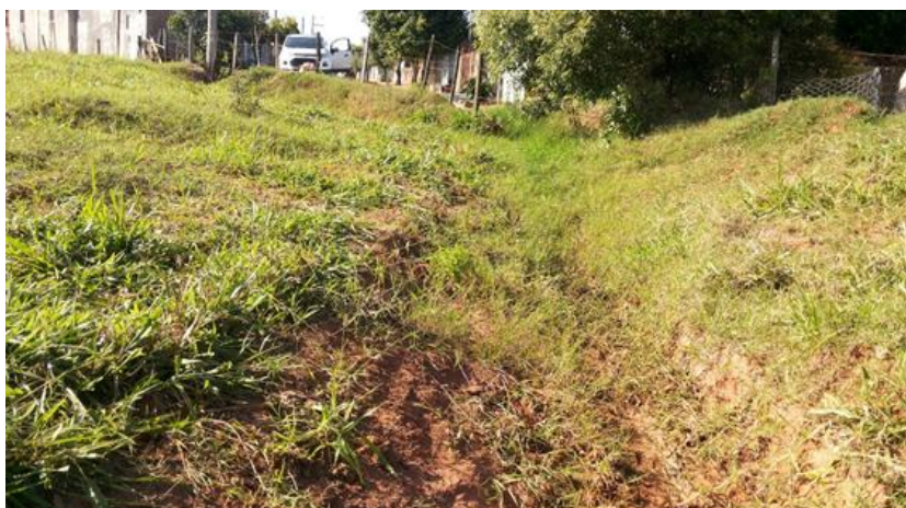
Imagem 11.1: Lançamento de águas pluviais em termino de rua sem estrutura de proteção.
