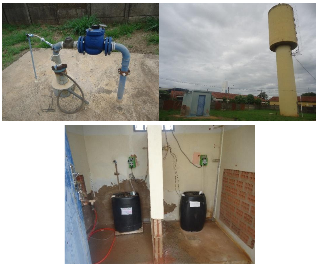
Imagem 9.2: P-01, respectivo reservatório e casa de cloro e flúor.
