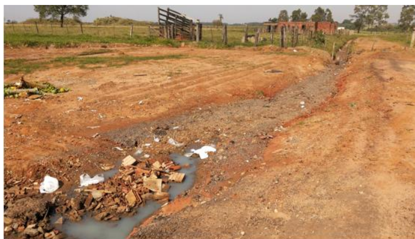
Imagem 11.9: Lançamento de águas pluviais em término de rua.
