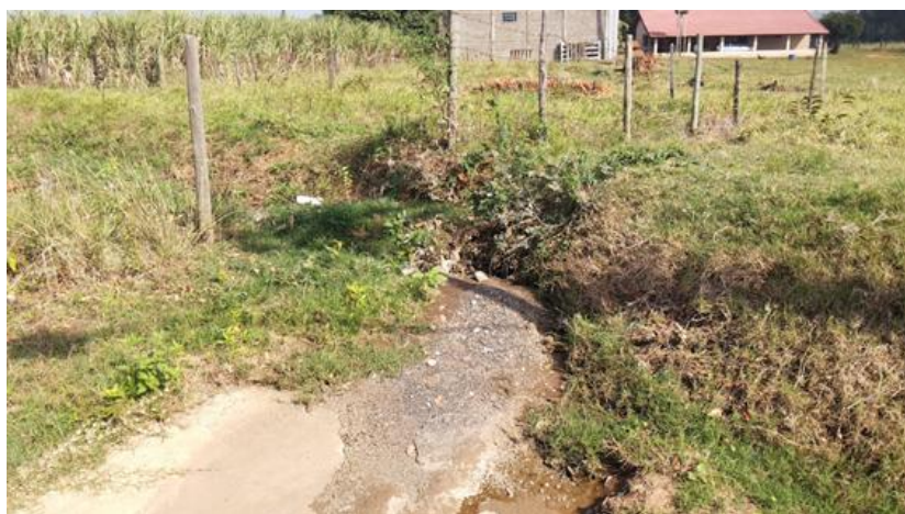
Imagem 11.8: Lançamento de águas pluviais em curva de contenção.
