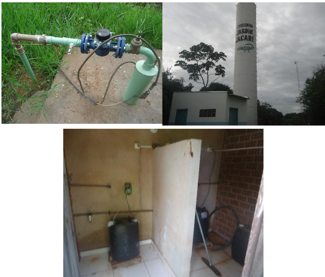
Imagem 9.6: P-05, respectivo reservatório e casa de cloro e flúor.
