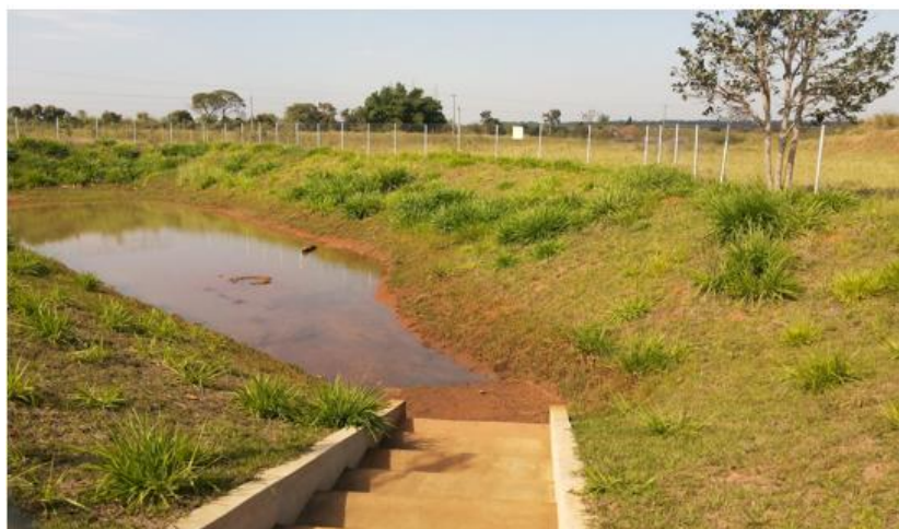
Imagem 11.12: Dispositivo de entrada na bacia de contenção.
