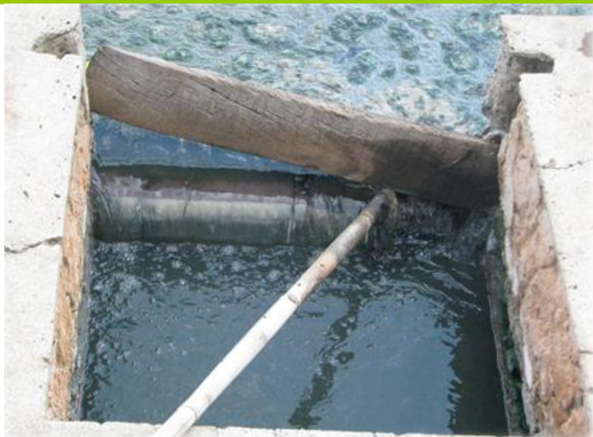
Imagem 10.4: Vista do dispositivo de saída da lagoa anaeróbia.
