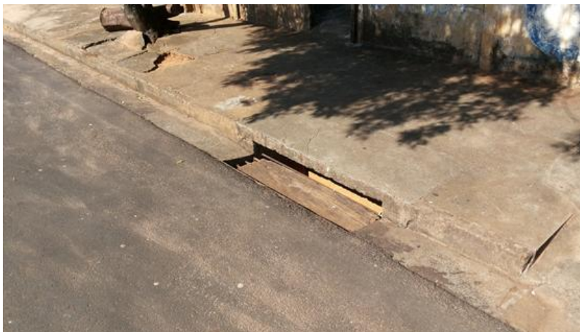
Imagem 11.7: Boca de lobo com obstrução.
