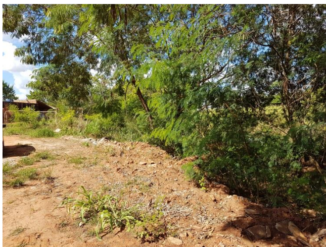
Foto 3.22 – Erosão causada pelo escoamento superficial
