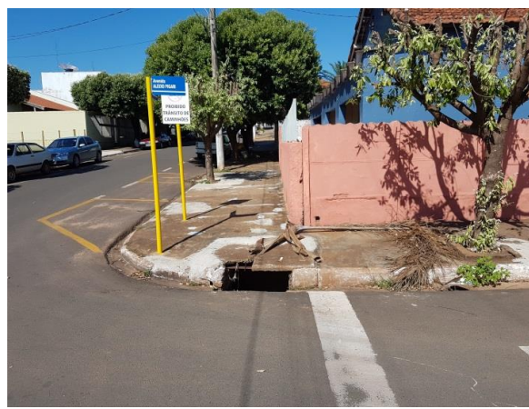
Foto 3.13 – Estrutura de microdrenagem insuficiente
