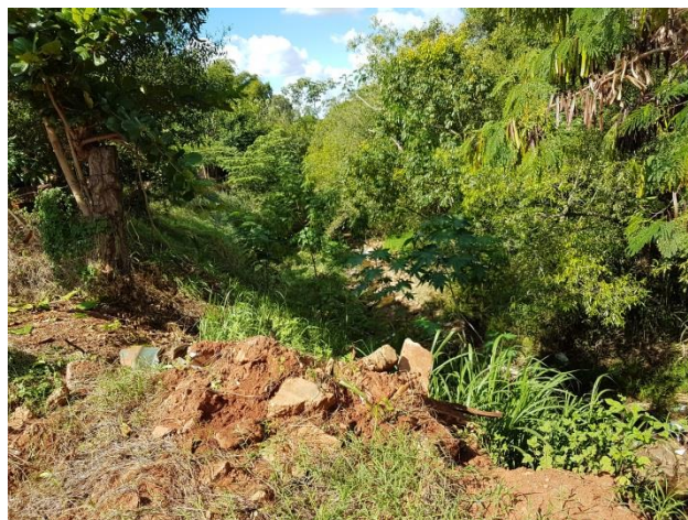
Foto 3.25 – Erosão causada pelo escoamento superficial
