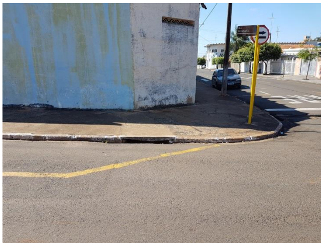
Foto 3.14 – Boca de lobo subdimensionada
