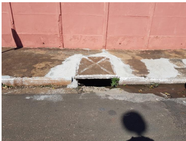
Foto 3.12 – Estrutura de microdrenagem insuficiente
