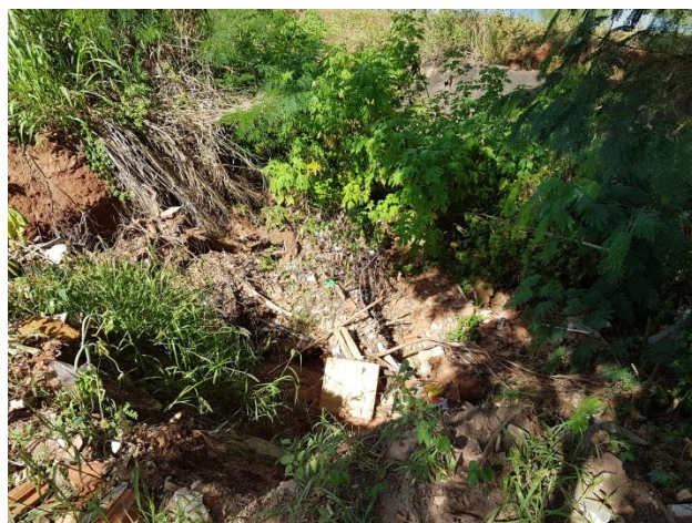
Foto 3.23 – Erosão causada pelo escoamento superficial
