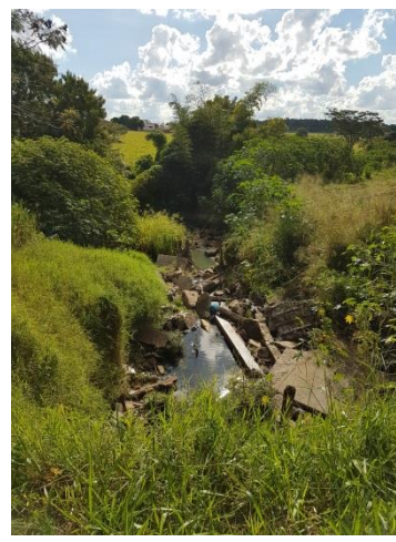
Foto 3.17 – Erosão e deposição de resíduos na calha do córrego da Varação
