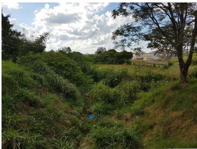
Foto 3.16 – Assoreamento do Córrego da Varação
