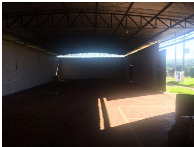
Foto 3.7 - Vista da área de armazenamento de pneus
