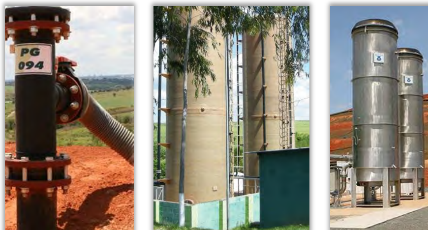
Figura 7.119 - Sistema de captação e queima de gás
