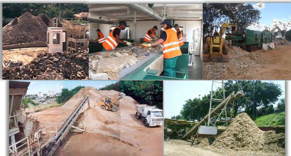
Figura 8.81 - Central de Beneficiamento de RCC
