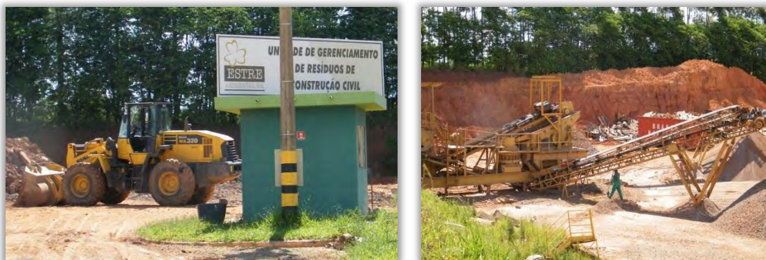
Figura 7.125 – Unidade de gerenciamento de RCC
