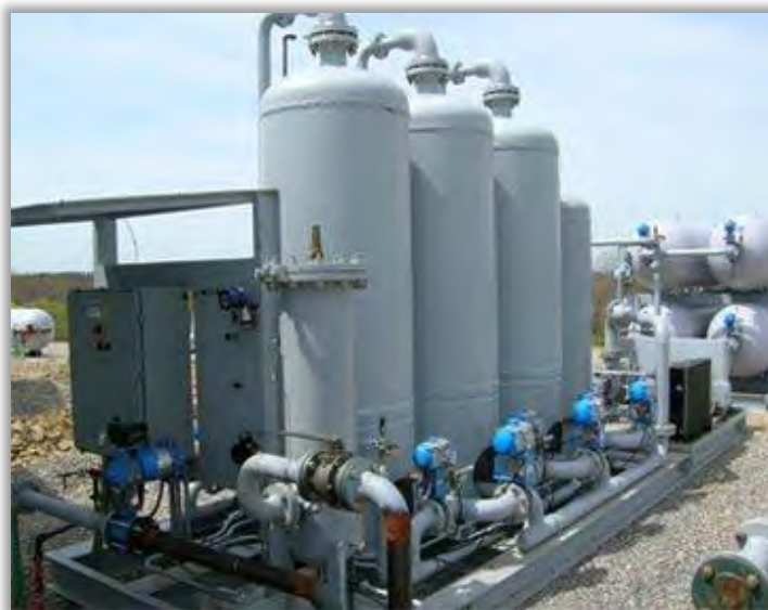
Figura 5.32 – Instalações da usina de purificação.
