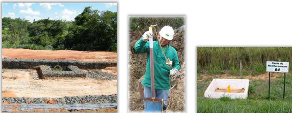
Figura 7.121 – Sistema de drenagem de águas pluviais e monitoramento ambiental
