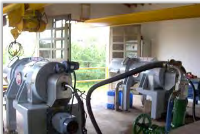
Figura 7.74 – Equipamento para desidratação do lodo. Fonte: DAEV
