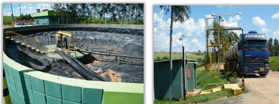
Figura 7.120 – Coleta, armazenamento e transporte de lixiviado
