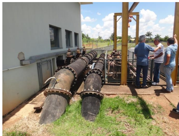
Foto 4.8 – Adutoras de Água Bruta e Tratada
