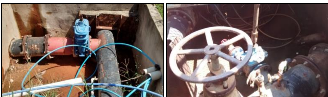
Figura 67 - Válvulas de manobra, dispositivos de macromedição e telemetria e EEAT Felicidade.
