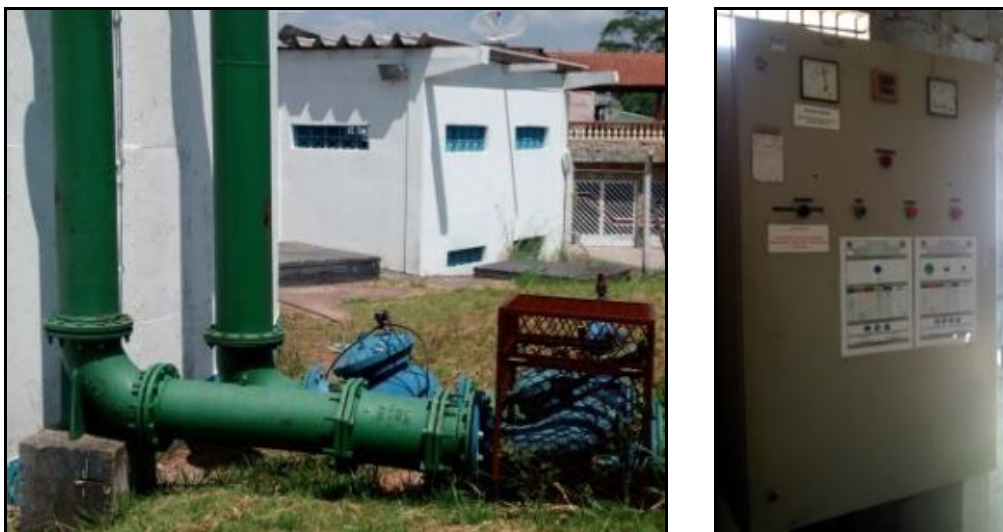
Figura 79 - Vista externa da EEAB e do painel de comando das bombas.
