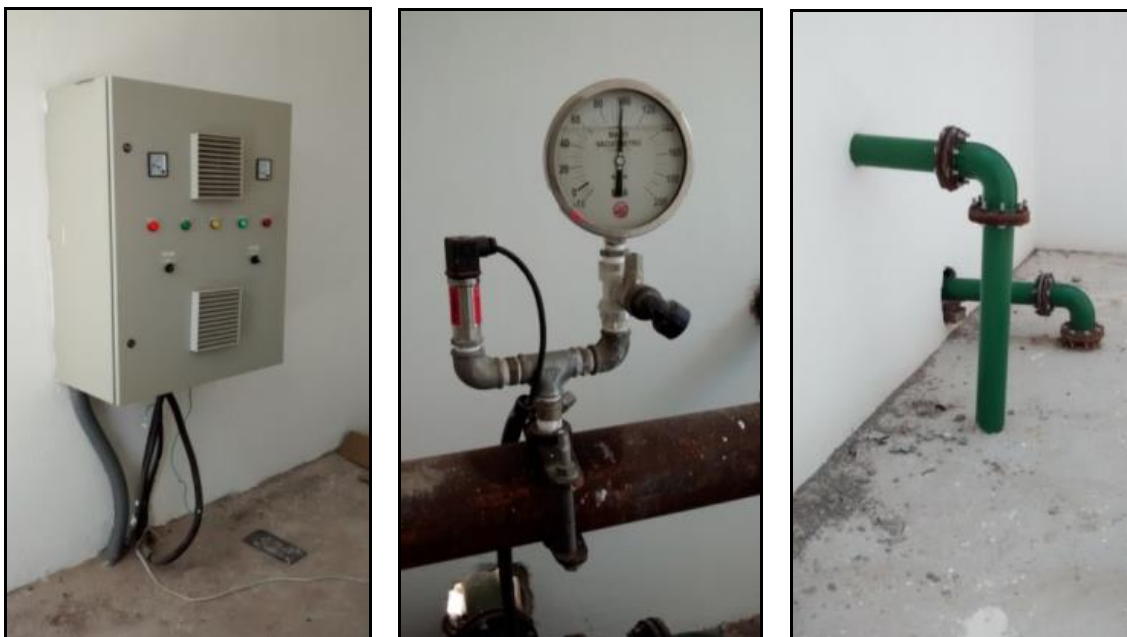
Figura 82 - Vistas do painel, manômetro e tubulações do Booster.
