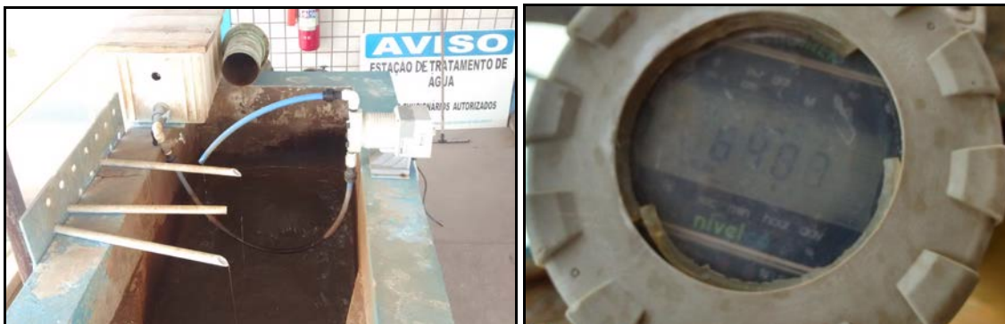
Figura 44 - Dosadores de produtos químicos e display do macromedidor de entrada da ETA.
