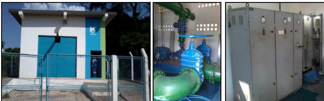
Figura 83 - Vistas da área externa bombas, tubulações e painéis do Booster Olívio Moura.
