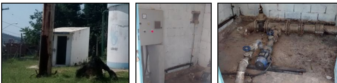
Figura 84 - Vistas da área externa e da bomba do booster Promeca.
