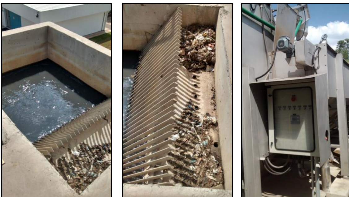
Figura 130 - Unidade de Gradeamento do Tratamento Preliminar e Painel de controle dos Desarenadores Mecanizados.
