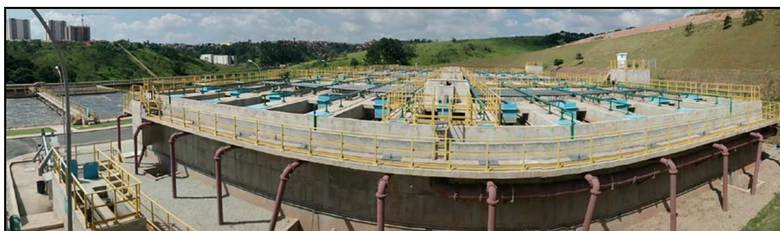
Figura 133 - Vista geral dos Reatores UASB da ETE.
