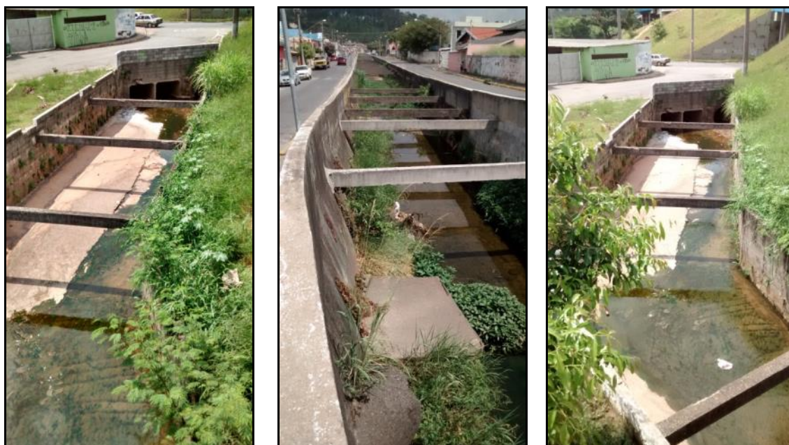
Figura 187 - Trecho final da canalização do Córrego Pinheirinho com problemas de crescimento de vegetação e pontos de rachaduras no fundo de concreto.
