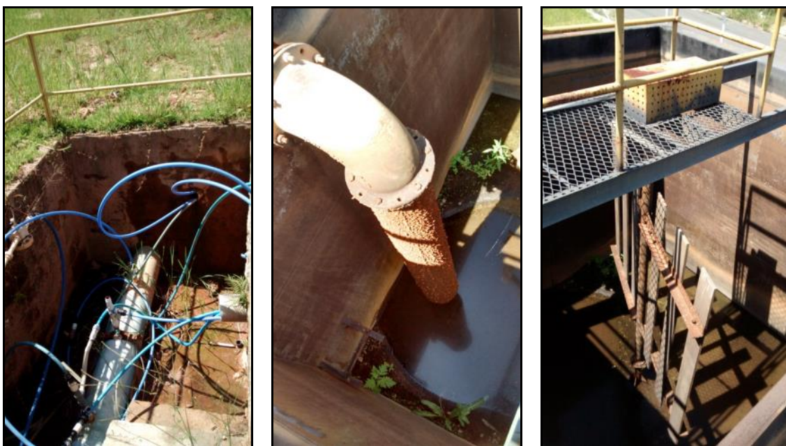
Figura 62 - Sistema de macromedicação e telemetria da água vinda da ETA Campo Limpo e unidades da ETA desativada.
