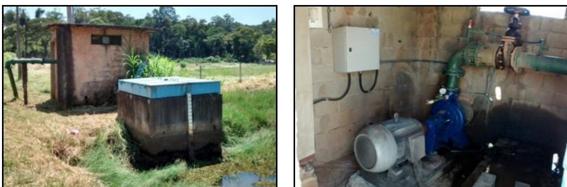
Figura 23 - Abrigo das bombas, caixa de tomada d'água e bomba instalada na captação.
