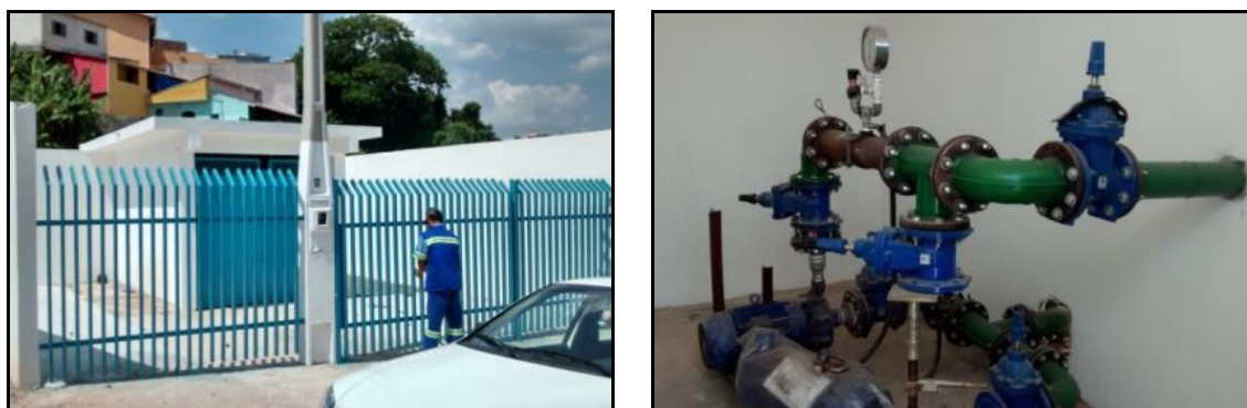
Figura 81 - Vistas externa e interna do Booster Cidade Nova.
