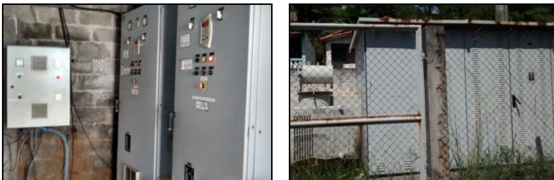
Figura 66 - Detalhes dos painéis das bombas e da Subestação de energia da EEAT Felicidade.
