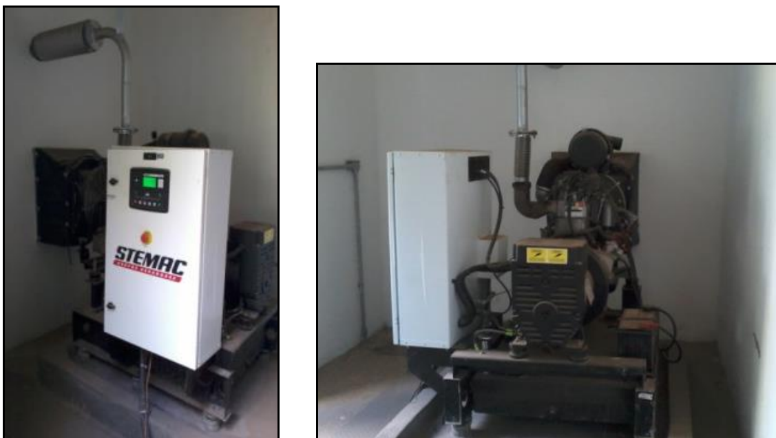
Figura 118 - Vistas do interior da EEEB Vila Real – gerador de energia a diesel.
