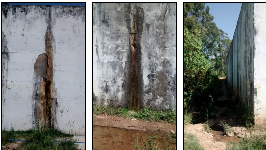
Figura 93 - Evidências de vazamento nas paredes laterais dos reservatórios Promeca.
