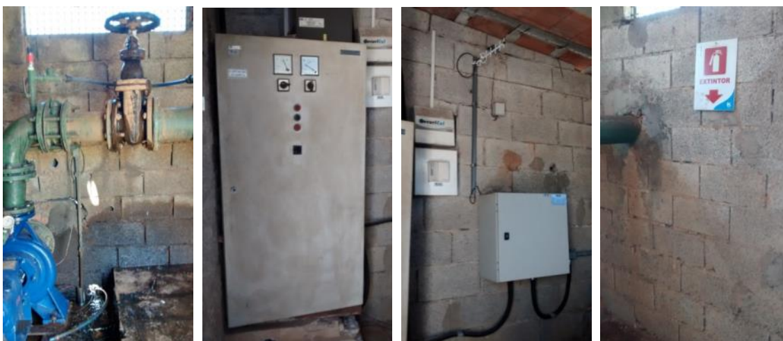
Figura 24 - Vista da bomba com vazamentos na tubulação, painéis de comando e a identificação da falta do extintor de incêndio no local.
