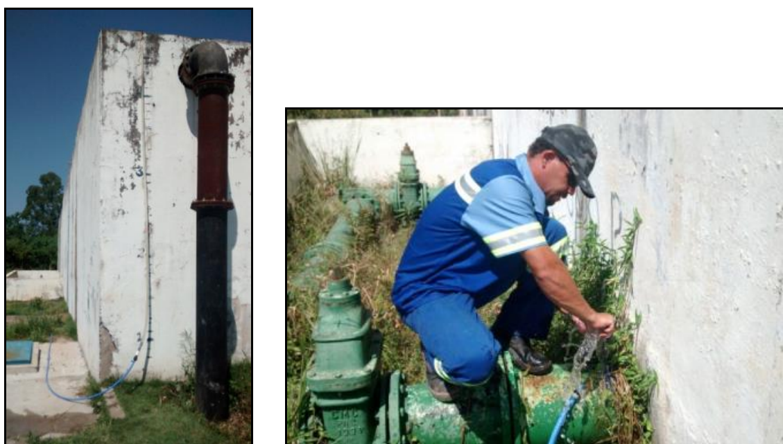
Figura 94 - Medidor de nível e funcionário da SABESP arrumando a mangueira do medidor de nível que se encontrava desconectada devido à utilização pelos moradores da região.
