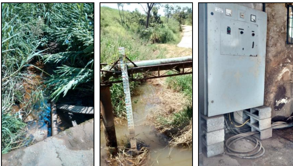
Figura 20 - Vistas do local da captação identificando as más condições de conservação do local, a régua de nível do ponto de captação e o painel da bomba instalada no local.
