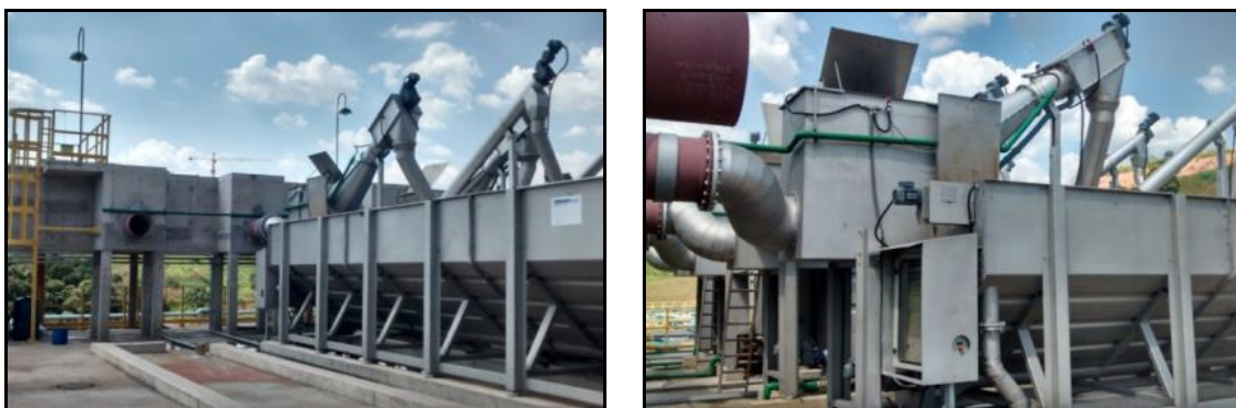
Figura 131 - Unidades de Gradeamento e Desarenadores Mecanizados.
