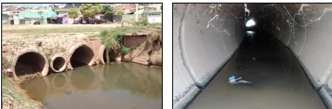
Figura 178 - Tubulações de travessia do Córrego Bertioga sob praça existente próximo à sua foz. Observa-se estrangulamentos na seção do canal, com área insuficiente para escoamento das vazões de cheia e falta de planejamento nas obras realizadas.
