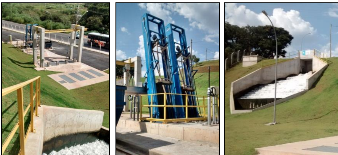
Figura 142 - Vistas da EEEB Final (chegada do efluente bruto) e da Escada de Aeração Final (saída do efluente tratado).
