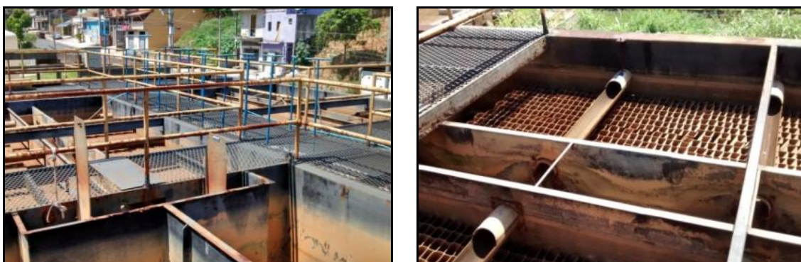
Figura 61 - Vista do topo dos decantadores desativados e detalhe de seus módulos tubulares e calhas de coleta.
