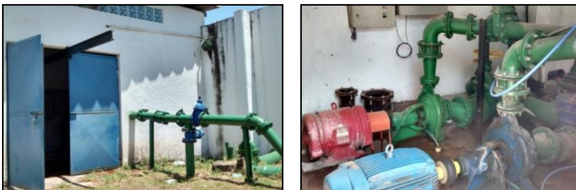
Figura 76 - Vista do abrigo do sistema de bombeamento do reservatório Tanque Velho.
