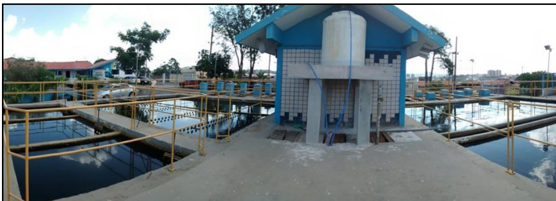
Figura 41 - Vista Geral da Estação de Tratamento de Água Palmeiras.
