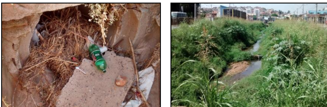
Figura 177 - Falta de manutenção comprometendo a seção do canal bem como a seção da travessia. Pode-se observar também o assoreamento neste trecho do córrego Bertioga.
