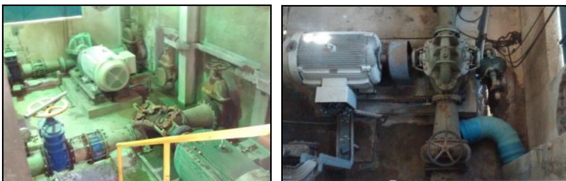
Figura 65 - Vista do interior da casa de bombas e detalhe da bomba centrífuga em funcionamento e suas tubulações de sucção e recalque.
