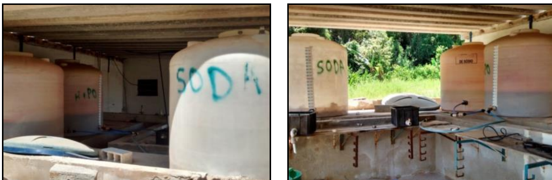
Figura 63 - Tanques de armazenamento de produtos químicos ainda com produtos armazenados mesmo com a ETA estando desativada.
