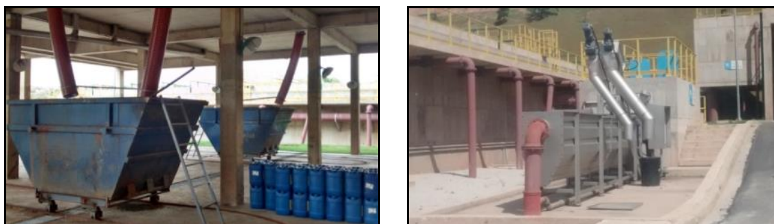
Figura 132 - Caçamba de armazenamento dos resíduos do tratamento preliminar e Elevatória de recirculação interna dos Reatores Aeróbios.
