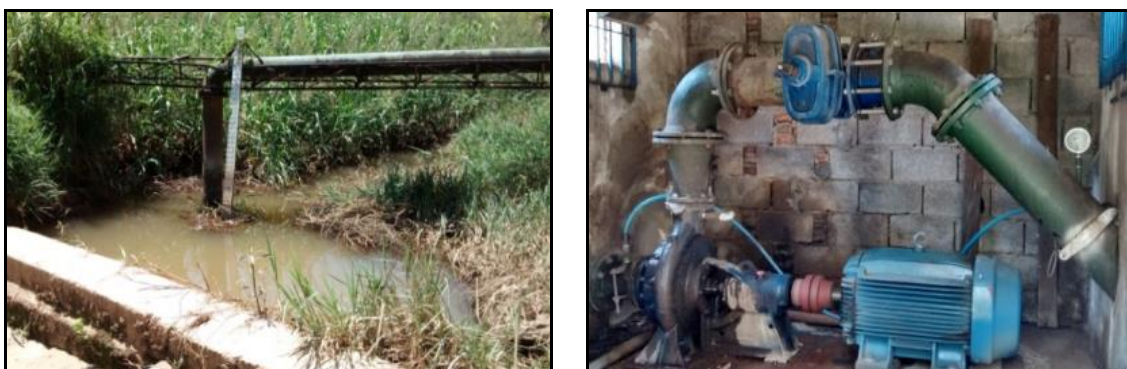
Figura 19 - Vistas do local da captação do Córrego Moinho identificando a área de reservação do córrego para sucção e bomba instalada no interior do abrigo.
