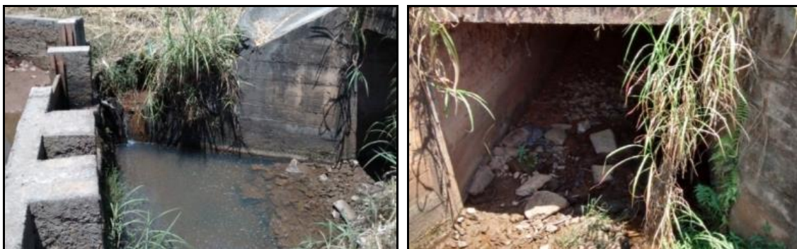
Figura 22 - Local do barramento em mal estado de conservação e manutenção.
