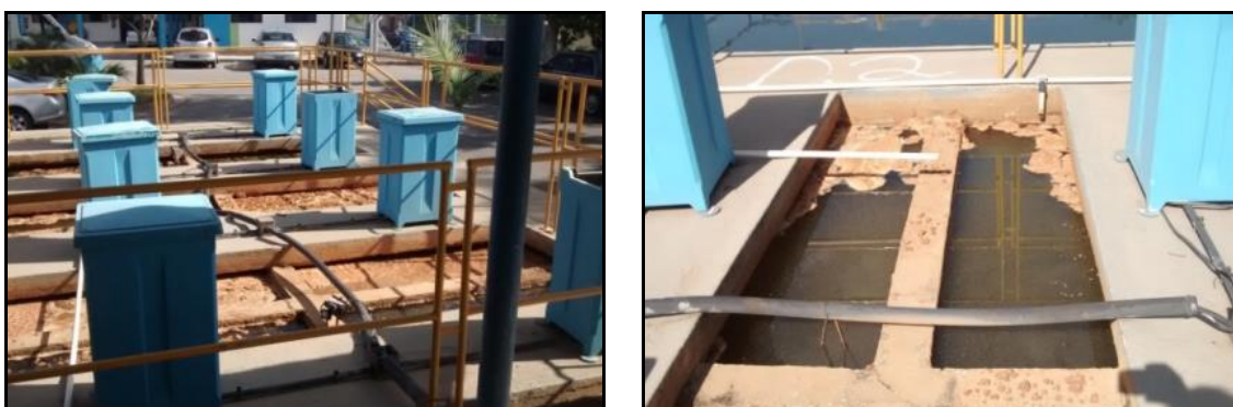
Figura 45 - Flocculadores e equipamentos de floculação da ETA Palmeiras.
