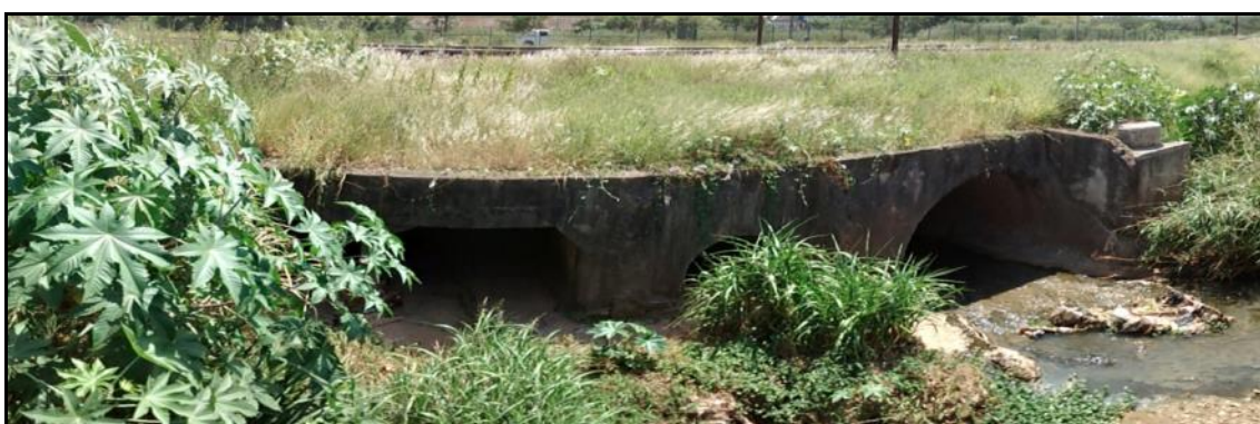
Figura 179 - Ponto de travessia do córrego Bertioga junto à sua foz no Rio Jundiá - diversos problemas de assoreamento e depósito de entulho.
