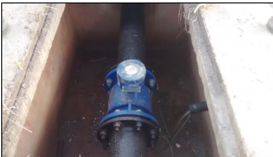
Figura 109 - Macromedidor e dispositivo de controle instalados na Rede de Distribuição.
