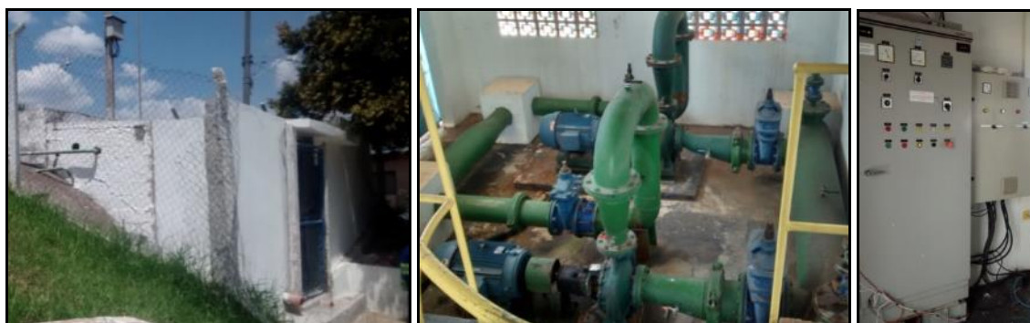
Figura 80 - Vistas da área externa, interna e do painel de controle das bombas do booster Cemitério.
