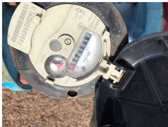
Figura 103. Vista do hidrômetro instalado no local.
