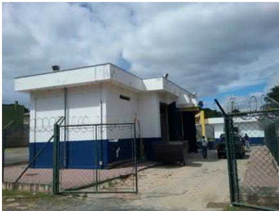
Figura 172. Estação Elevatória de Esgoto – Igaratá (Marambaia) - Vista 1.
