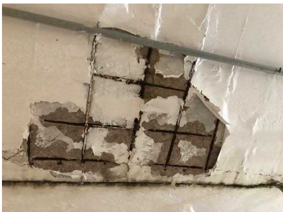
Figura 66. Vista da armadura do filtro evidenciando a necessidade de manutenção.
