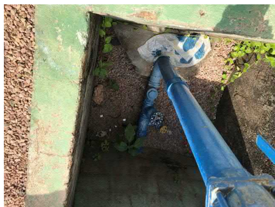
Figura 101. Vista do dispositivo de segurança (válvula de retenção).
