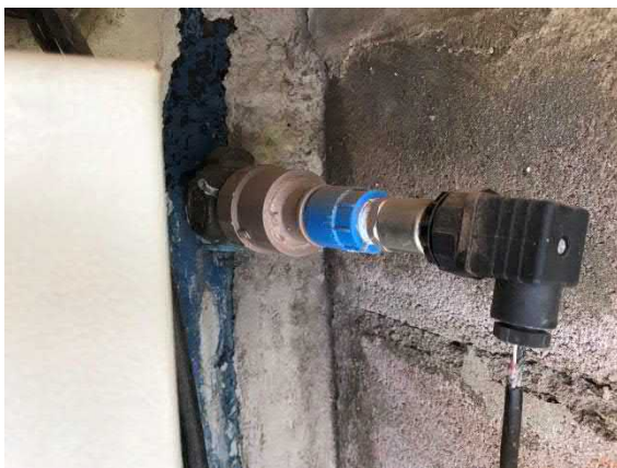
Figura 152. Vista do sensor de pressão para controle de nível.
