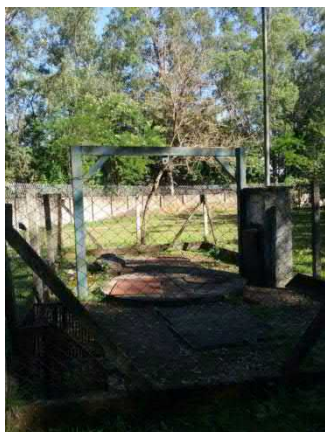
Figura 186. Estação Elevatória de Esgoto – Vista Alegre (Café 4) - Vista 1.
