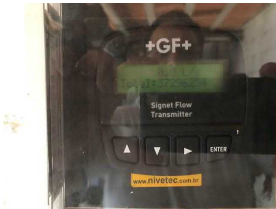
Figura 128. Vista do display do macromedidor instalado no local.
