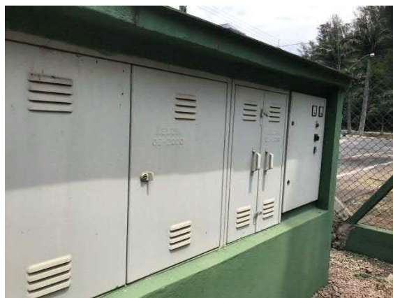
Figura 114. Vista geral do painel elétrico.
