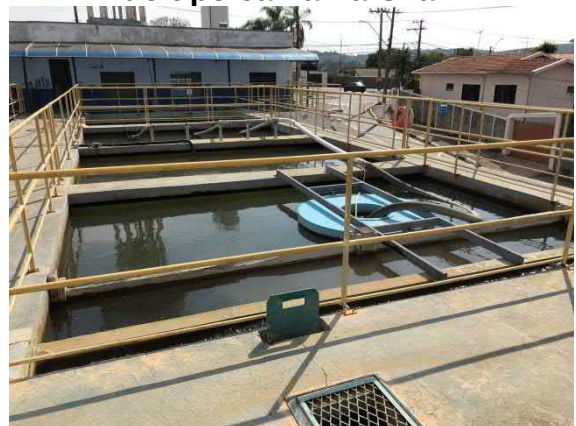
Figura 57. Vista dos tanques decantadores.
