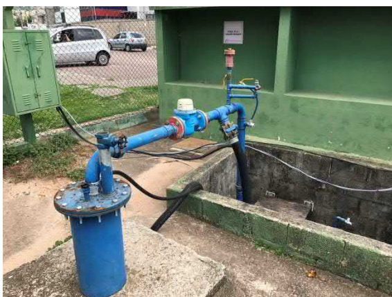
Figura 104. Vista geral do barrilete.
