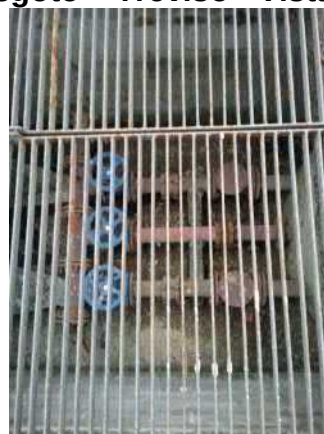
Figura 179. Estação Elevatória de Esgoto – Treviso - Vista 4.
