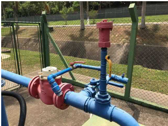
Figura 107. Vista do barrilete da bomba e macromedidor de vazão.
