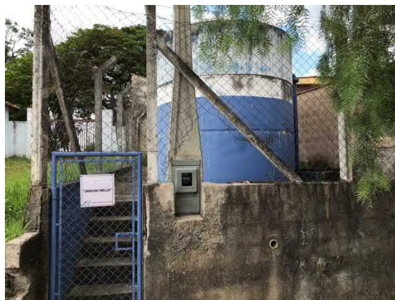
Figura 149. Vista do reservatório apoiado de 23m 3 .
