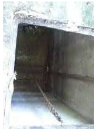
Figura 163. Estação Elevatória - Vida Nova III - Vista 4.
