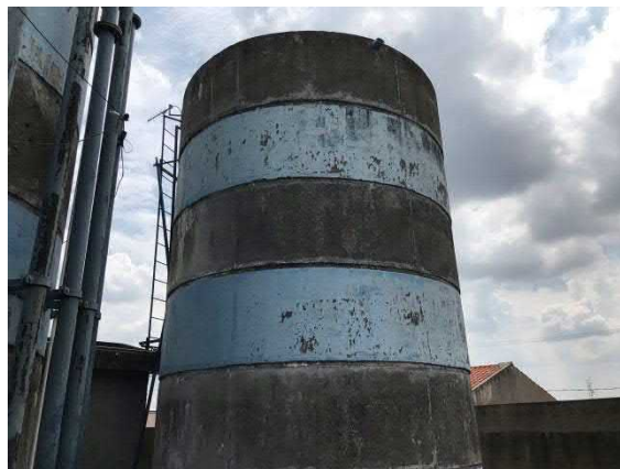
Figura 132. Vista do reservatório apoiado de 50m 3 .
