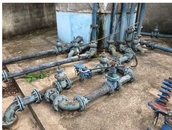
Figura 134. Vista geral do barrilete de distribuição com registros de manobras e válvulas de segurança.
