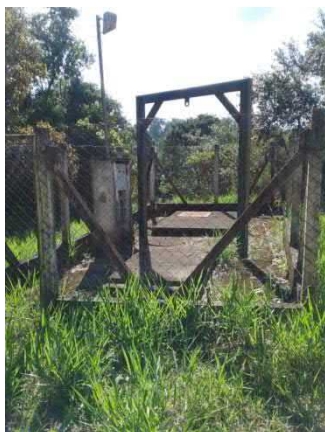
Figura 180. Estação Elevatória de Esgoto – Vista Alegre (Café 1) - Vista 1.
