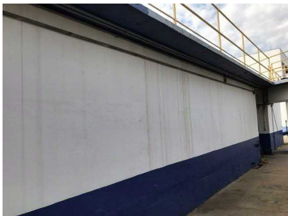
Figura 64. Vista externa do tanque de decantação (verifica-se princípio de infiltração).
