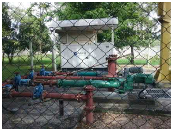
Figura 169. Estação Elevatória de Esgoto – Barra do Saí (Marambaia) - Vista 2.
