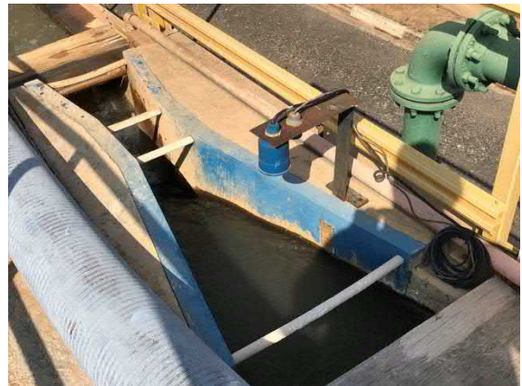
Figura 55. Vista do medidor de vazão do tipo calha Parshall.
