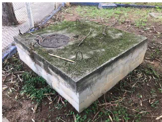
Figura 145. Vista da saída do reservatório para rede de distribuição.
