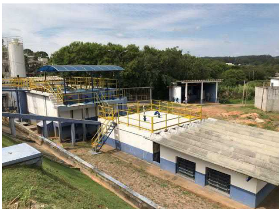
Figura 78. Vista geral da ETA Santa Cândida.
