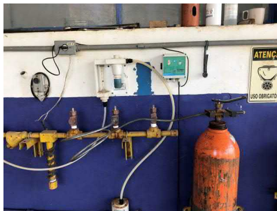
Figura 83. Vista do sistema de desinfecção por gás cloro.
