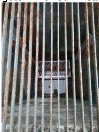
Figura 178. Estação Elevatória de Esgoto – Treviso - Vista 3.
