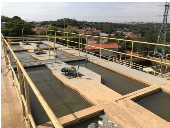
Figura 56. Vista dos tanques de floculação.
