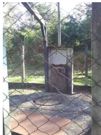
Figura 187. Estação Elevatória de Esgoto – Vista Alegre (Café 4) - Vista 2.
