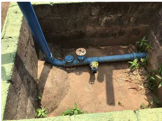
Figura 98. Vista da válvula de retenção.
