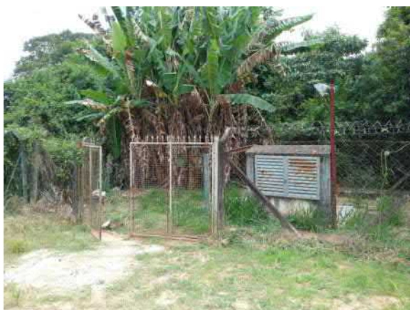
Figura 164. Elevatória de Esgoto – Alpes - Vista 1.
