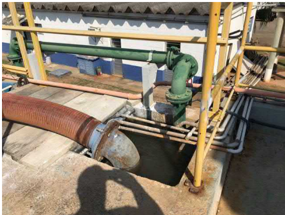
Figura 54. Vista da chegada da água bruta.
