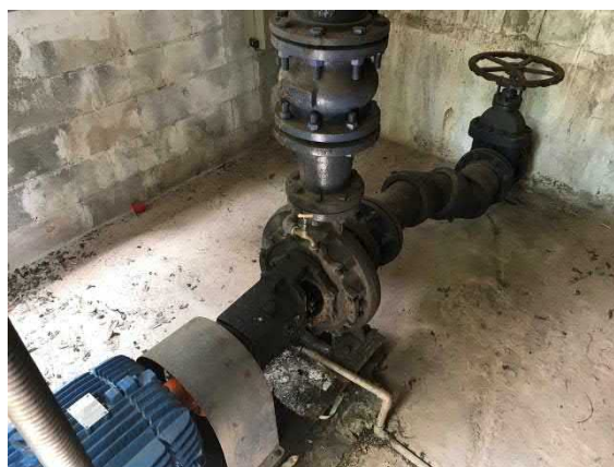
Figura 130. Vista da estação elevatória de água tratada do Vista Alegre.
