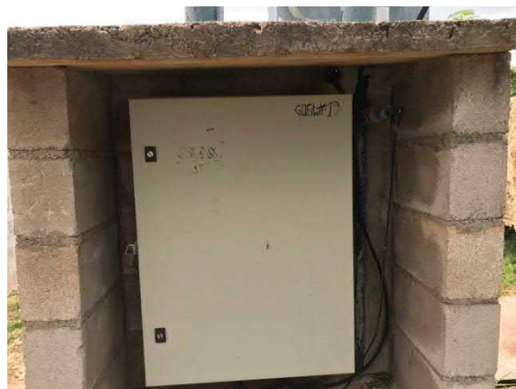
Figura 153. Vista do painel de telemetria de nível instalado neste sistema.
