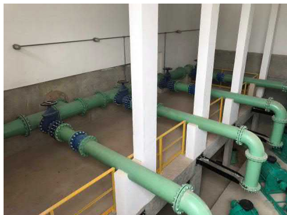
Figura 91. Vista do barrilete de recalque de água tratada.
