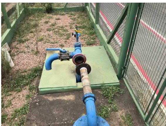
Figura 111. Vista do local de instalação do macromedidor de vazão.
