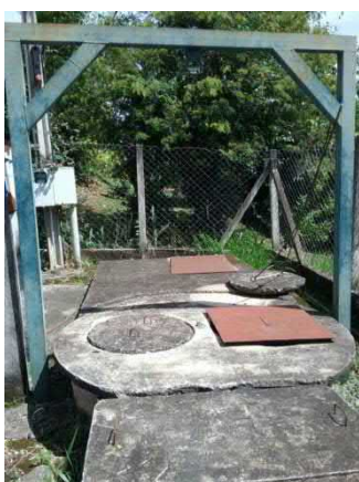
Figura 188. Estação Elevatória de Esgoto – Vista Alegre (Sede) - Vista 1.
