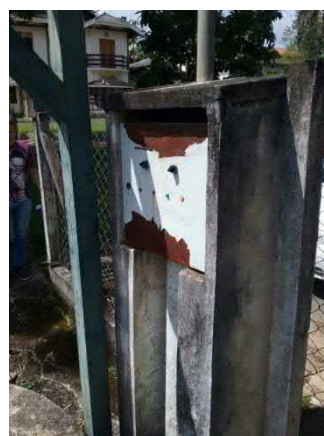
Figura 189. Estação Elevatória de Esgoto – Vista Alegre (Sede) - Vista 2.
