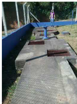
Figura 167. Estação Elevatória de Esgoto – Casa Verde - Vista 2.
