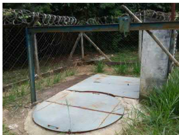
Figura 165. Elevatória de Esgoto – Alpes - Vista 2.
