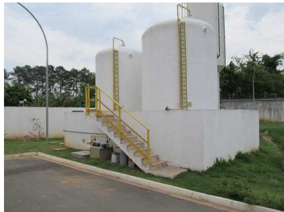
Figura 95. Vista dos tanques de armazenamento de produtos químicos.
