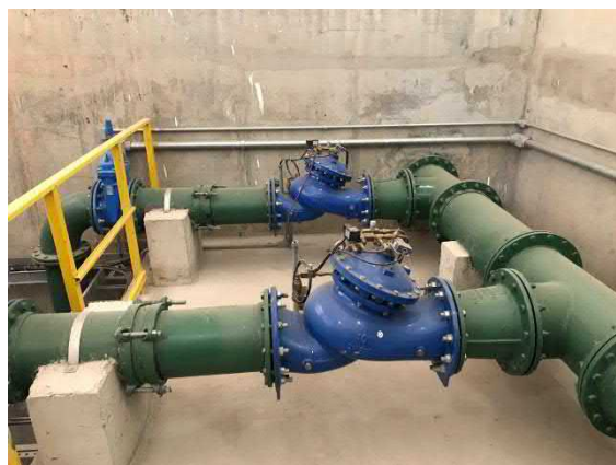
Figura 89. Vista das válvulas de retenção auto operadas.
