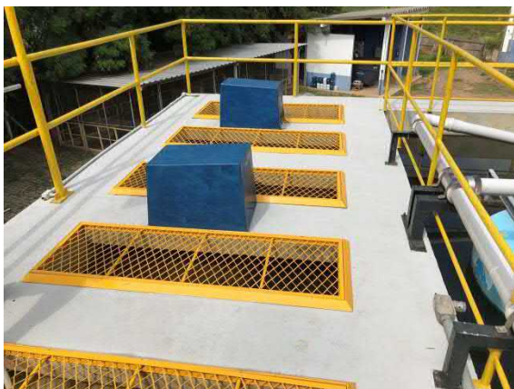
Figura 80. Vista dos módulos de floculadores.
