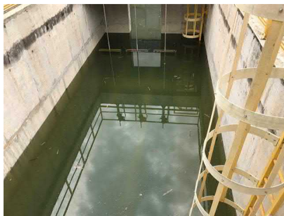
Figura 87. Vista do poço de sucção de água bruta.
