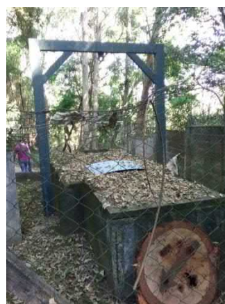
Figura 185. Estação Elevatória de Esgoto – Vista Alegre (Café 3) -Vista 2.
