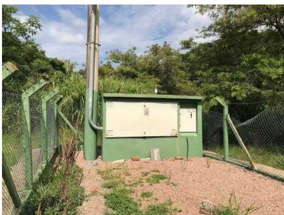
Figura 100. Vista do padrão de entrada de energia elétrica.
