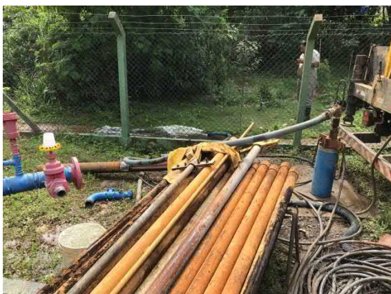
Figura 113. Vista do local de instalação do macromedidor de vazão.
