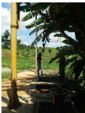
Figura 158. Estação Elevatória - Vida Nova III (Principal) - Vista 1.
