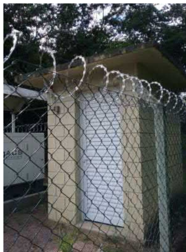
Figura 171. Estação Elevatória de Esgoto – Barra do Saí (Marambaia) - Vista 4.
