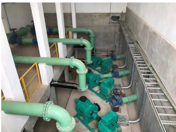
Figura 92. Vista dos conjuntos de recalque de água tratada.
