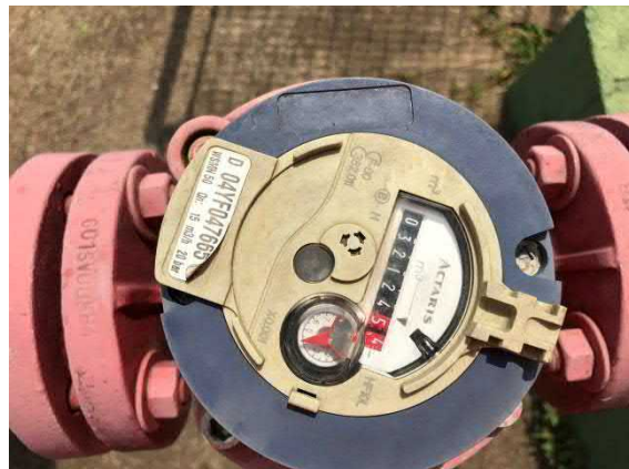
Figura 97. Vista do macromedidor de vazão instalado.
