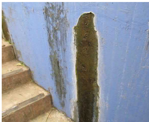
Figura 126. Vista dos pequenos vazamentos encontrados neste sistema de reservação.
