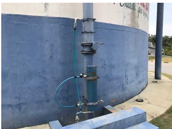
Figura 117. Vista do sistema de cloração por pastilha de hipoclorito.
