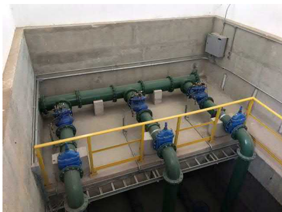
Figura 88. Vista do barrilete de recalque da água bruta.
