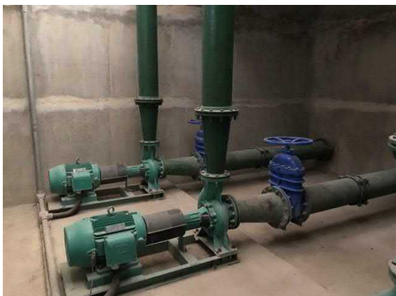
Figura 90. Vista das bombas de recalque de água bruta.
