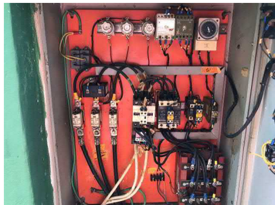
Figura 99. Vista do painel elétrico da bomba submersa.
