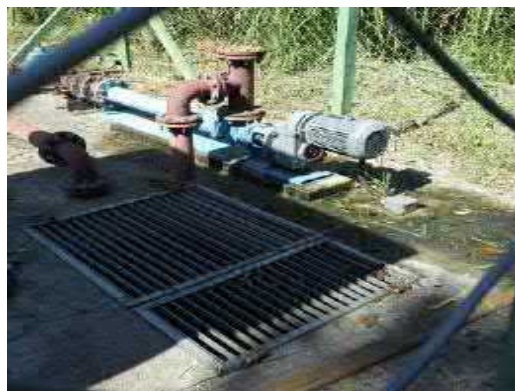
Figura 157. Vista do Conjunto Moto Bomba.
