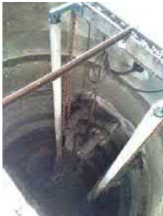
Figura 162. Estação Elevatória - Vida Nova III - Vista 3.
