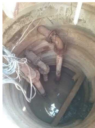
Figura 191. Estação Elevatória de Esgoto – Vista Alegre (Sede) - Vista 4.
