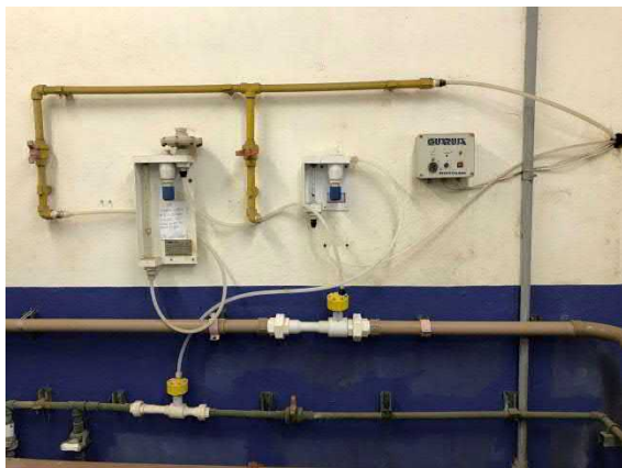
Figura 62. Vista do sistema de aplicação de cloro gás.
