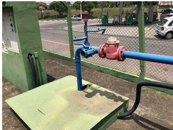
Figura 108. Vista geral do local da bomba.
