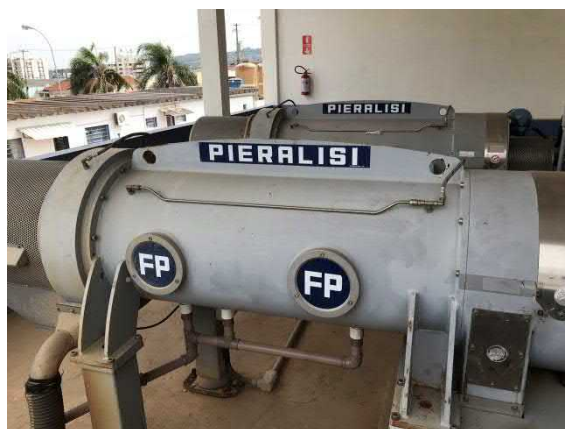
Figura 71. Vista das centrifugas desaguadoras de lodo.
