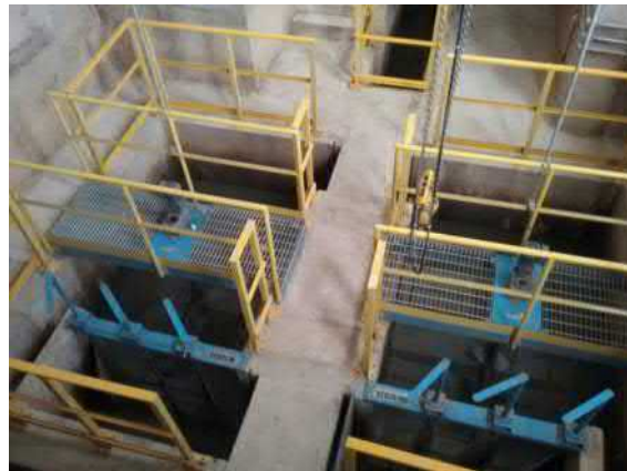
Figura 173. Estação Elevatória de Esgoto – Igaratá (Marambaia) - Vista 2.
