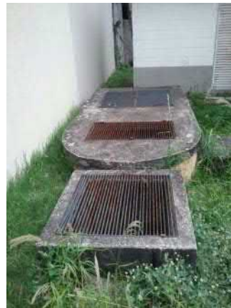
Figura 177. Estação Elevatória de Esgoto – Treviso - Vista 2.
