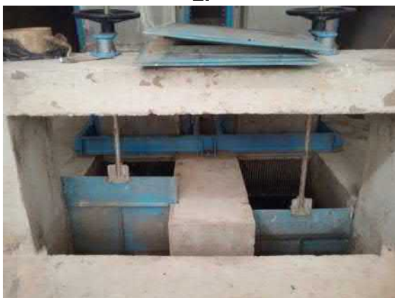
Figura 174. Estação Elevatória de Esgoto – Igaratá (Marambaia) - Vista 3.
