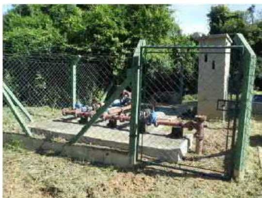
Figura 156. Estação Elevatória Jardim Florido.
