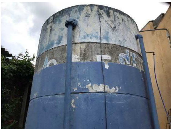
Figura 148. Vista do reservatório apoiado de 23m 3 .
