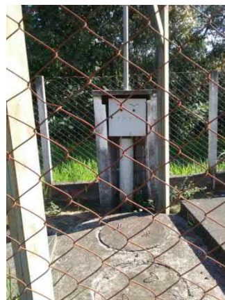
Figura 181. Estação Elevatória de Esgoto – Vista Alegre (Café 1) - Vista 2.
