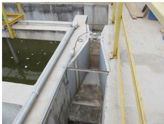
Figura 85. Vista do medidor de vazão do tipo calha parshall.
