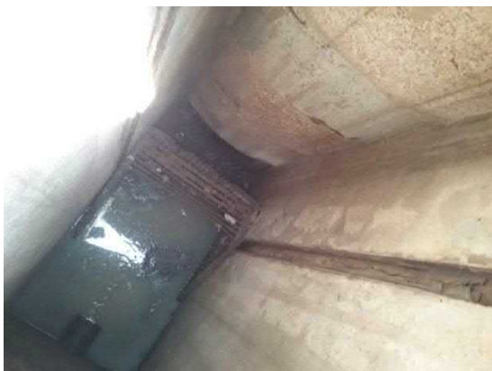
Figura 190. Estação Elevatória de Esgoto – Vista Alegre (Sede) - Vista 3.
