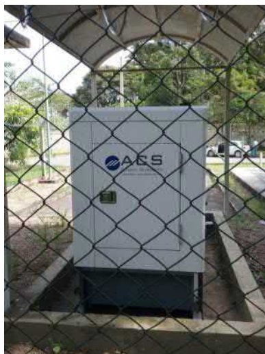
Figura 170. Estação Elevatória de Esgoto – Barra do Saí (Marambaia) - Vista 3.
