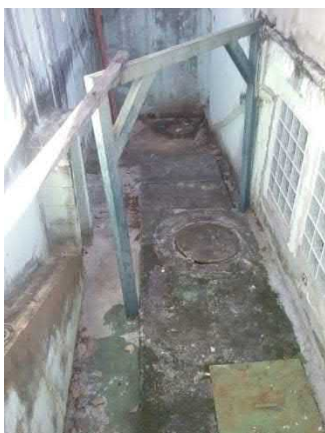
Figura 182. Estação Elevatória de Esgoto – Vista Alegre (Café 2) - Vista 1.
