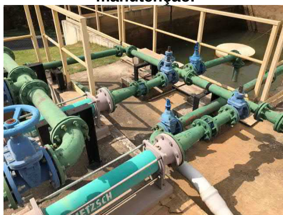
Figura 69. Vista das bombas de recalque de lodo.
