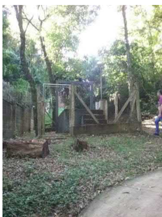
Figura 184. Estação Elevatória de Esgoto – Vista Alegre (Café 3) -Vista 1.
