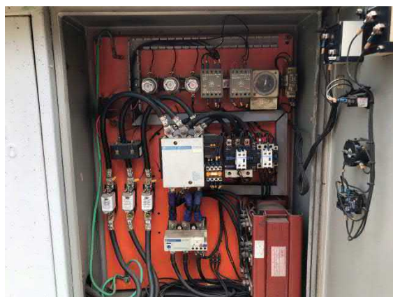
Figura 110. Vista do painel da bomba instalada.
