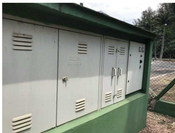
Figura 112. Vista geral do painel elétrico.
