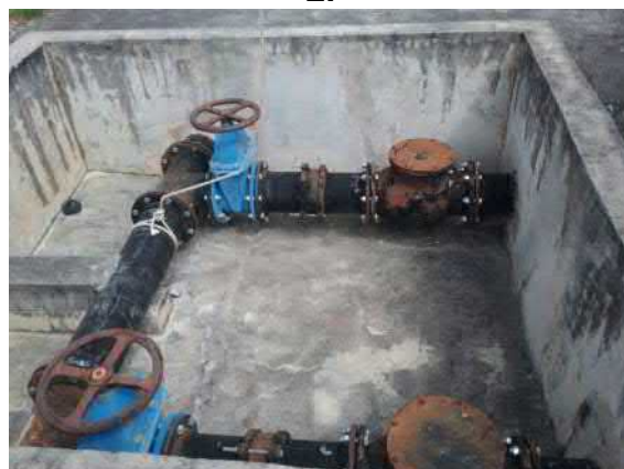
Figura 175. Estação Elevatória de Esgoto – Igaratá (Marambaia) - Vista 4.
