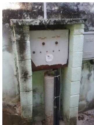
Figura 183. Estação Elevatória de Esgoto – Vista Alegre (Café 2) - Vista 2.
